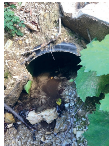
Slika 4. Začepljen ulaz cijevnog propusta Figure 4. Buried pipe culvert entrance
