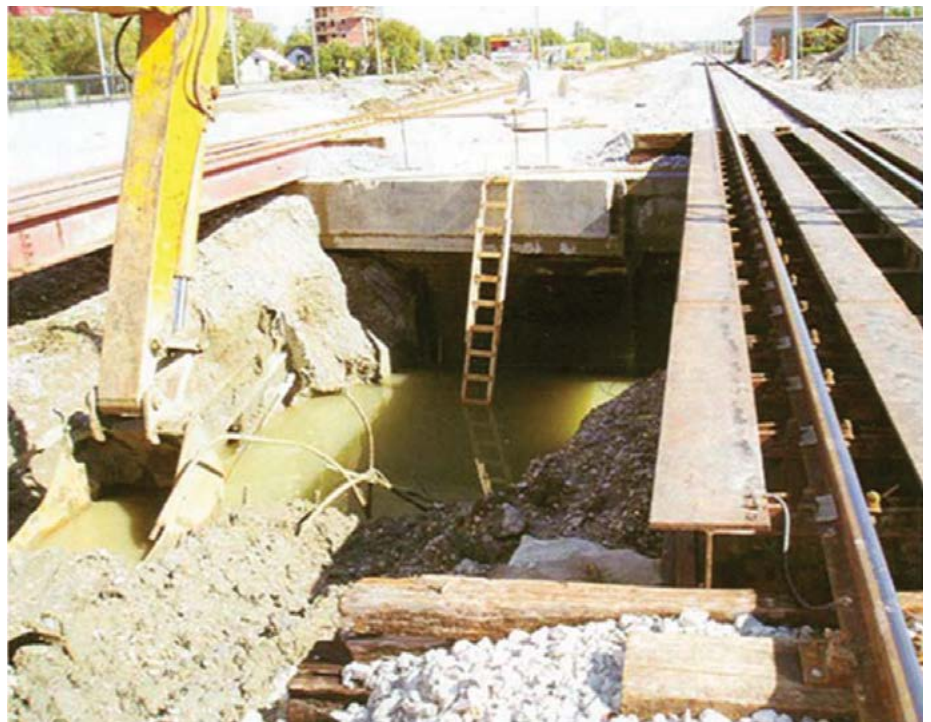
Slika 3. Pojava podzemne vode prilikom iskopa za pothodnik na stajalištu Čulinec u čvorištu Zagreb
