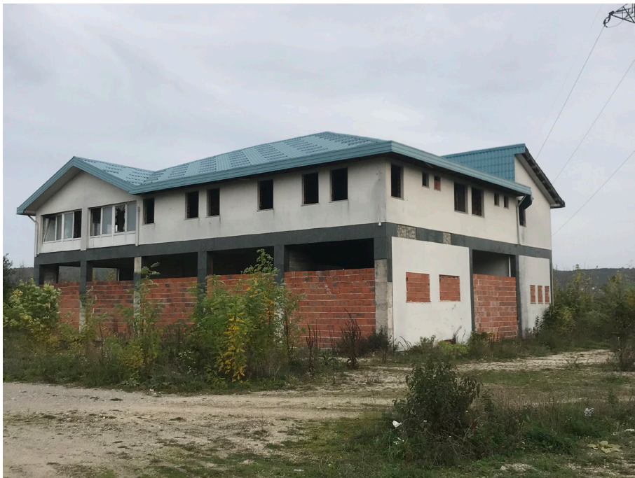
Prilog 15. Privatni poslovni prostor sa zazidanim ulazima na način na koji su se zazidavali i drugi objekti da bi se spriječilo njihovo korištenje i boravak izbjeglica, oko zgrade se nalazila odbačena odjeća i prazna prehrambena ambalaža, Bihać, 24. 10. 2022. Fotografirala Tea Škokić.
