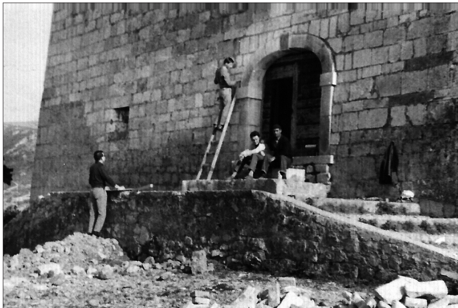
Sl. 5. Arhitektonsko snimanje ulaznog portala i pristupnog stubišta tvrđave Nehaj 1963. godine (foto: Laszlo Fuderer, izvor: privatni arhiv Vladimira Berkovića)
