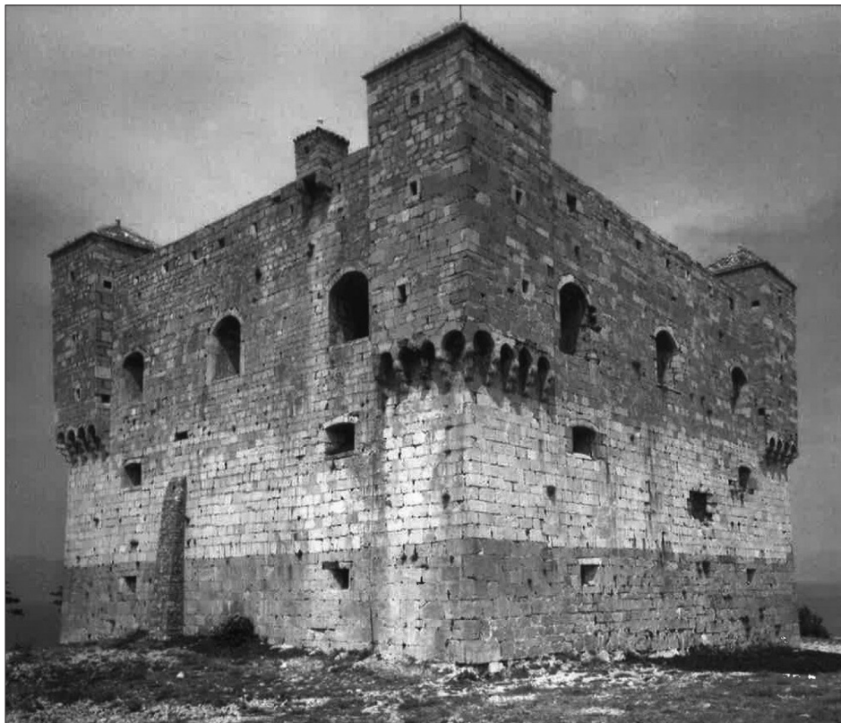
Sl. 2. Oštećenje istočnog pročelja tvrđave Nehaj (izvor: Senj, stradanja u Drugom svjetskom ratu , 2010, 133)
