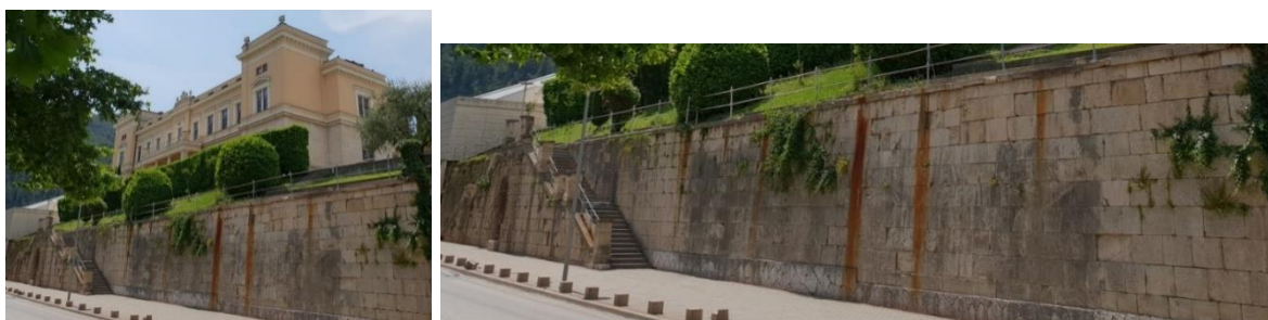
Slike 6.-7. Razni oblici promjena na kamenu u potpornom zidu Biskupijskog dvora u Mostaru (fizički utjecaj atmosferske vode, oštećenja od ratnih djelovanja, biokolonizacija, oštećenja nastala korozijom željezne ograde, sidrenih u kamen, koji korodiraju u dodiru s vlagom, a promjenom volumena nastaje raspucavanje kamena, kao i višemetarske okomite mrlje na kamenu, koje se vrlo teško uklanjaju; Kamen u objektu Biskupijskog dvora je saniran nakon rata, (foto: K. Šaravanja), [21]
