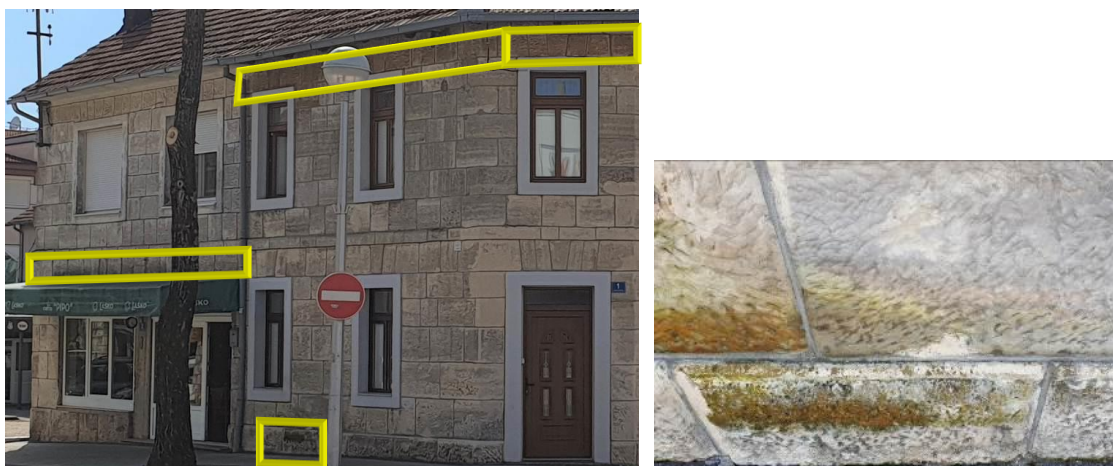
Slike 25.-26. Utjecaj atmosfere vode ispod oluka krova i iznad tende na kući u Posušju od (posuške) miljevine, jače izražen u donjem dijelu objekta uslijed kapilarnog porasta oborinske vode (i snijega), sa detaljem (gljivice i lišajevi), (foto: K. Šaravanja), [21]
