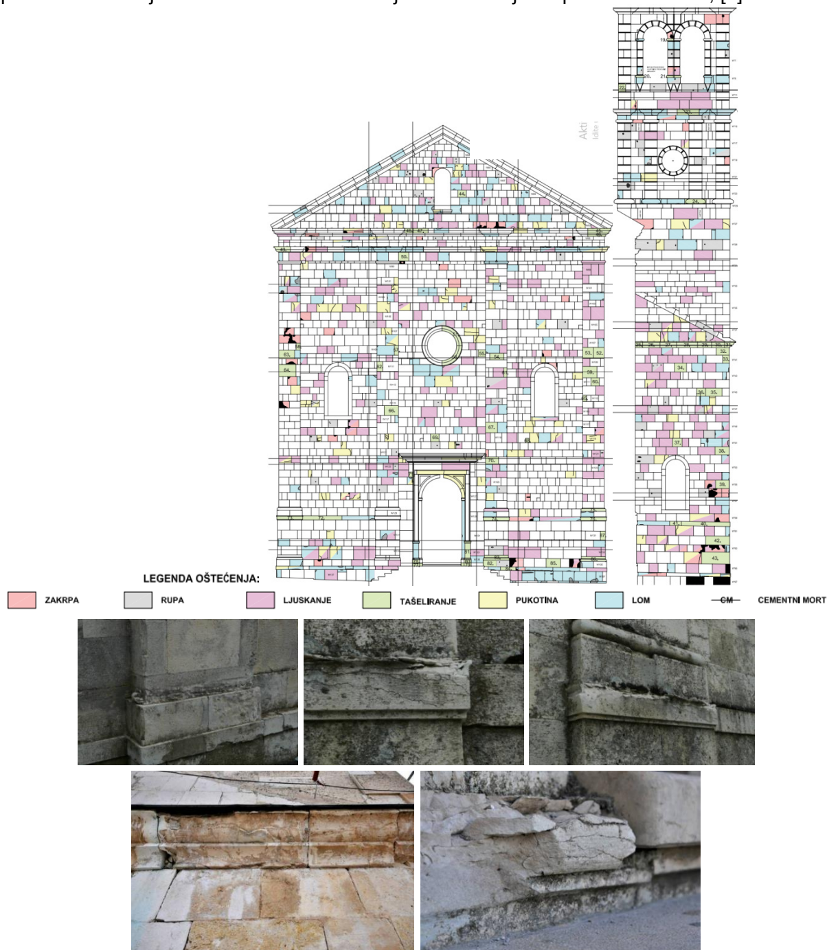
Slike 31.-37. Shema oštećenja zapadnog pročelja (lijevo) i zapadnog pročelja južnog zvonika crkve sv. Petra i Pavla na Gorici u Livnu (desno), (izradio: Hrvatski restauratorski zavod, Zagreb, 2011.); Nestajanje pojedinih dijelova baze pilastra zbog teškog oštećenja agresivnim klimatskim utjecajima; Potpuno uništeni dijelovi razdjelnog vijenca na vrhu sokla na zapadnom pročelju crkve; Također se zamjećuju naslage nižeg korova u obliku algi, lišajeva i mahovina (slike gore); Propadanje kamene plastike razdjelnog vijenca zapadne strane južnog zvonika zbog prodora atmosferilija i razaranja kamena procesima smrzavanja (dolje, lijevo); Detalj profilirane kamene plastike na kojemu su nastale pukotine, ljuskanje i odlamanje kamenog materijala (dolje, desno), [7]
