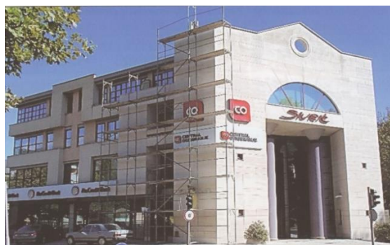
Slika 15. Skidanja patine s fasade na „Sivriča“ zgradi u Mostaru od tenelije (kraj 2016. godine), [22]
