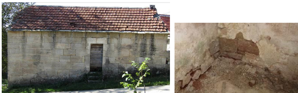
Slike 27.-28. Propadanje donjeg dijela sjeverne fasade (i temelja) kuće u Tomića Brigu kod Posušja, kao posljedica kapilarnog porasta oborinske vode i nanosa snijega, odnosno ciklusa smrzavanja u blizini tla; Zbog površine okolnog tla u nagibu, prisutno je površinsko tečenje vode i zalijevanje zida; Krov nije imao oluka, pa je kišnica padala s krova na tlo i odbijala se na fasadu zajedno sa česticama zemlje (lijevo); detalj unutrašnjosti kuće, kao ilustracija propadanja (desno), (foto: K. Šaravanja), [21]
