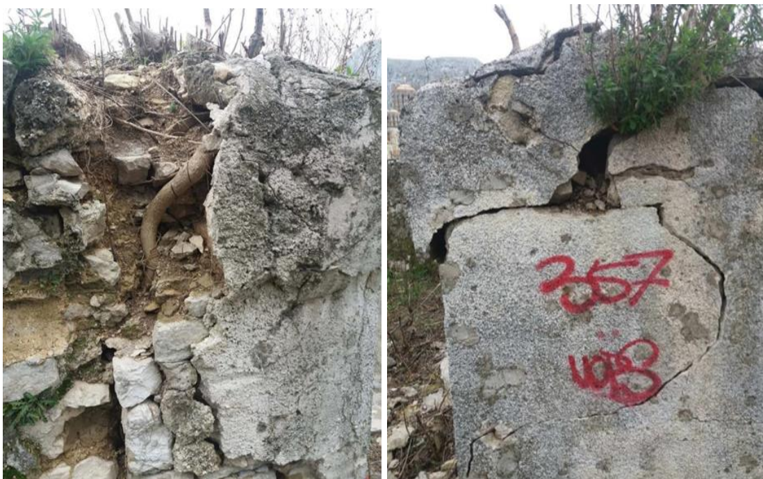
Slika 6. Oštećenje uzrokovano djelovanjem korijena
