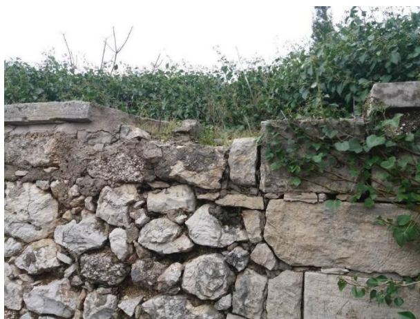
Slika 8. Nedostatak betonske kape
