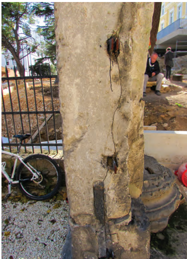
Sl. 9 Duboka i dugačka pukotina uzrokovana dilatacijom željeza na sjevernom pilastru (fotografija: Đ. Gobić-Bravar).
