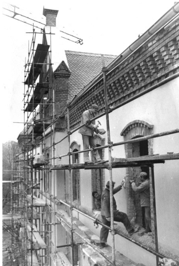
13. Rudolfova vojarna – adaptacija, 11. 12. 1985. (HDA HR DA 2031 Fond Vjesnik, snimka: D. Domitrović) Rudolf barracks – adaptation, 11 December 1985 (National Archives in Zagreb, HDA HR DA 2031 Fond Vjesnik, D. Domitrović)
