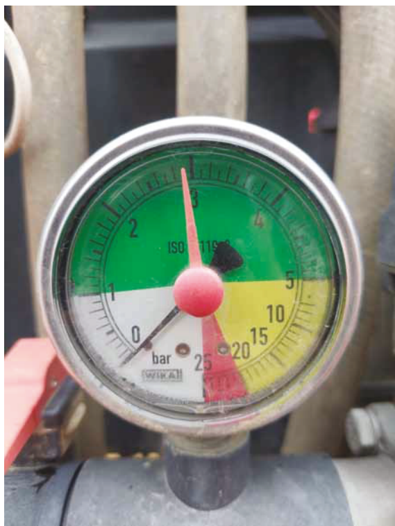
Slika 8. Manometar Figure 8. Manometer
