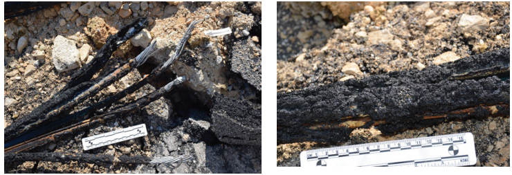
Slika 8. Tragovi gorenja na krajevima (a) i plaštu kabela (b)
