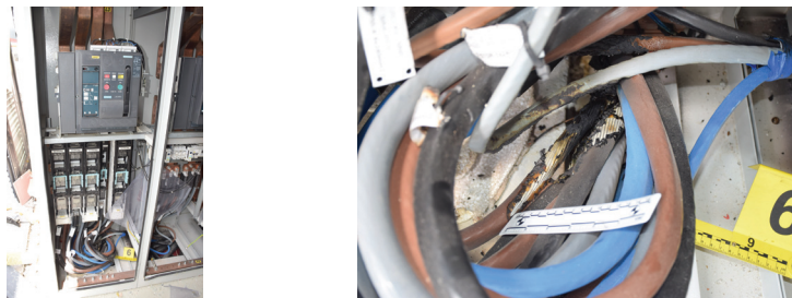
Slika 4. Opći (a) i bliži izgled (b) oštećenja kabela u glavnome razvodnom ormaru
