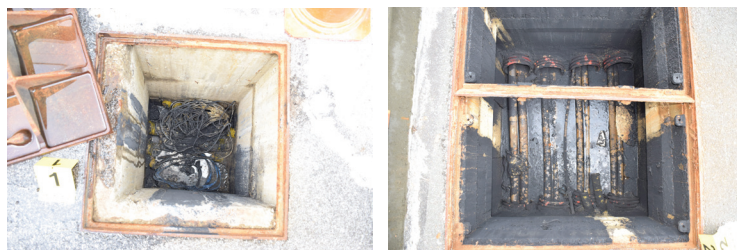
Slika 5. Tragovi termičkih oštećenja: a) na kablama, b) u šaftu
