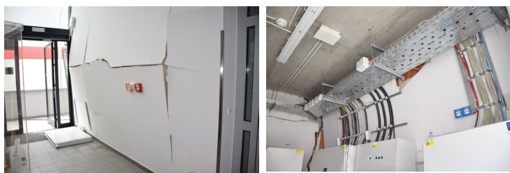
Slike 3 a i b. Mehanička oštećenja pregradnog zida: a) vanjska strana prostorije, b) unutarnja strana prostorije
