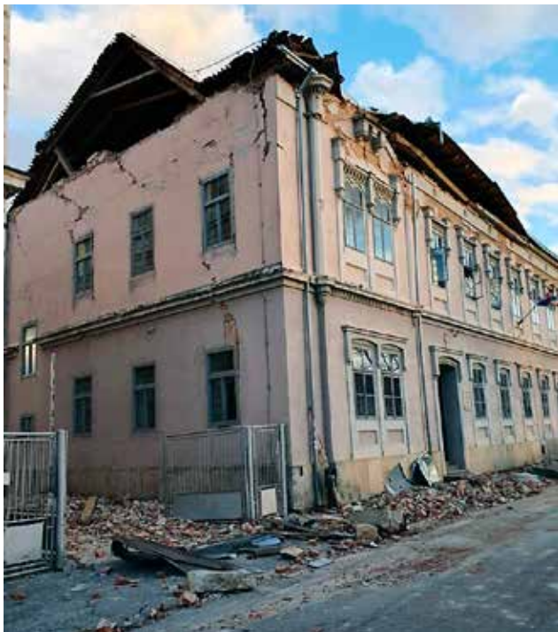
15 Osnovna škola u gradskom centru Petrinje (Baza HCPI, fotografije oštećenja građevina, 2020.)
