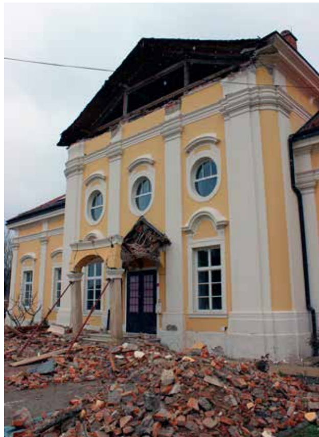
7 Zgrada Hrvatskog restauratorskog zavoda (MKM, fotografije oštećenja građevina za RDNA, 2020.)
