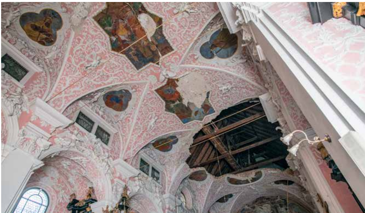
18 Progresivna oštećenja nakon petrinjskog potresa na crkvi Sv. Katarine Aleksandrijske na Gornjem gradu u Zagrebu (foto: M. Vujasinović, Intrados projekt d. o. o., 2021.)
