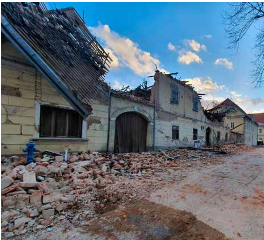
13 Petrinja: stambene zgrade na trgu Franje Tuđmana (Baza HCPI, fotografije oštećenja građevina, 2020.)
