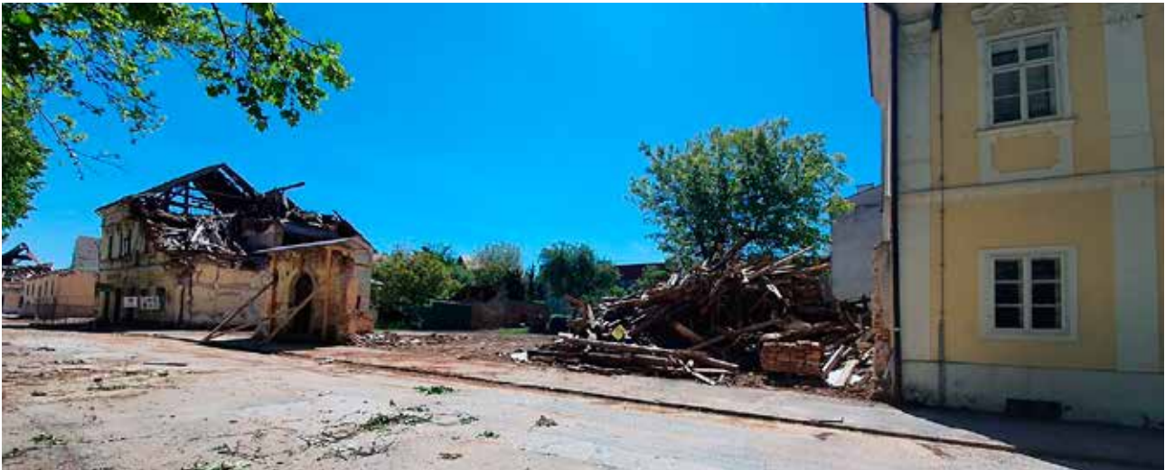
1 Uklonjene zgrade na Trgu Franje Tuđmana u Petrinji (Baza HCPI, fotografije oštećenja građevina, 2021.)
