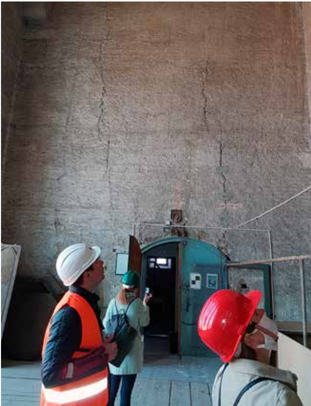
3 Zagreb, Katedrala Uznesenja BDM, popisni tim Gradskog zavoda za zaštitu spomenika kulture i prirode Grada Zagreba u pregledu oštećenja (foto: GZZSKP, 2020.)
