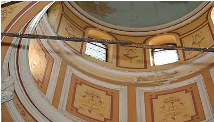
Pogled na oštećenja svodova i lukova malih i velikih arkada (gore) i puknuće zatege južnih arkada (dolje)
