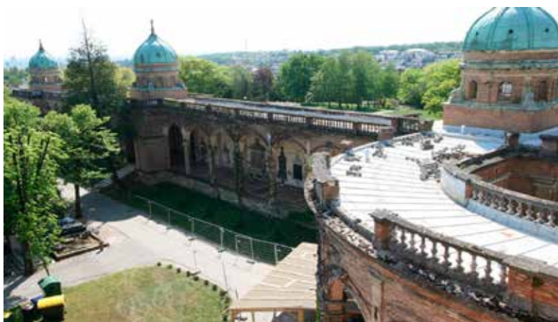
Pogled na urušeni zabat i napuknuće stupa malih arkada (gore) i urušenu balustradu južnih arkada (dolje)
