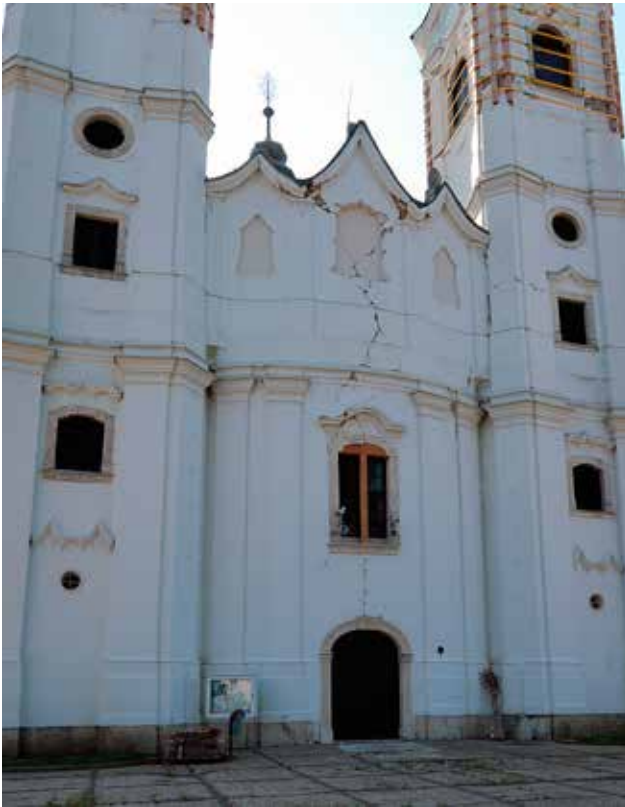
15 Cracking in the main façade (photo: X. Romão, July 2021) Pukotine na glavnom pročelju (foto: X. Romão, srpanj 2021.)
