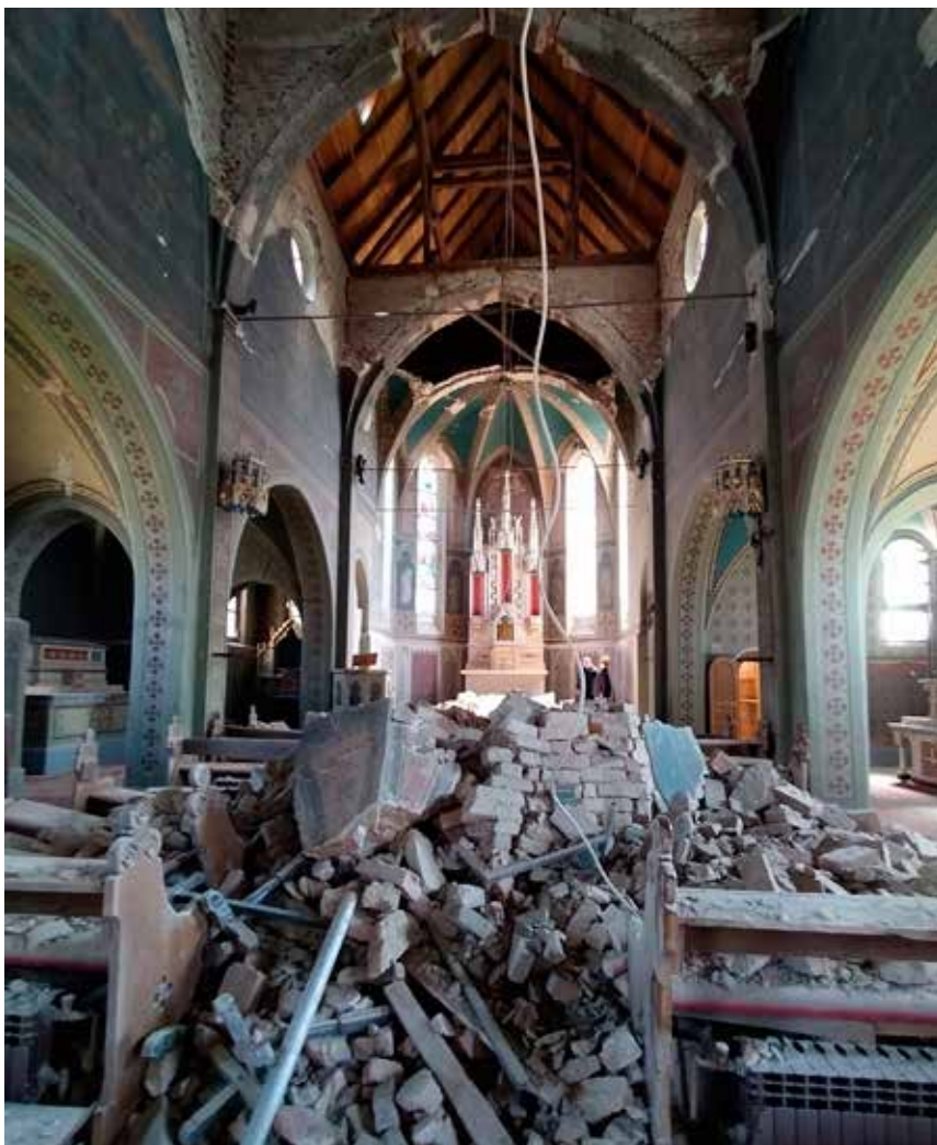
4 Oštećenja crkve Rođenja Blažene Djevice Marije u Granešini (fototeka GZZSKP, travanj 2020.)
