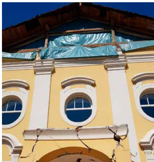
9 Ljetnikovac biskupa Galjufa u Grškovićevoj ulici nakon potresa iz ožujka 2020. (fototeka GZZSKP, travanj 2020.)
