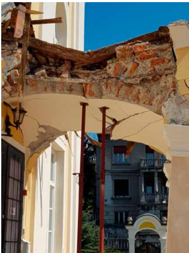
10 Detalj oštećenja ljetnikovca biskupa Galjufa u Grškovićevoj ulici nakon potresa iz ožujka 2020. (fototeka GZZSKP, travanj 2020.)
