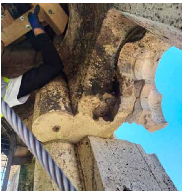
7 Detalj oštećenja sjevernog zvonika katedrale Uznesenja Marijina na Kaptolu (fototeka GZZSKP, travanj 2020.)
