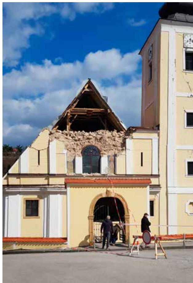
3 Oštećenja crkve Pohoda Blažene Djevice Marije u Čučerju (foto: S. Novak, ožujak 2020.)
