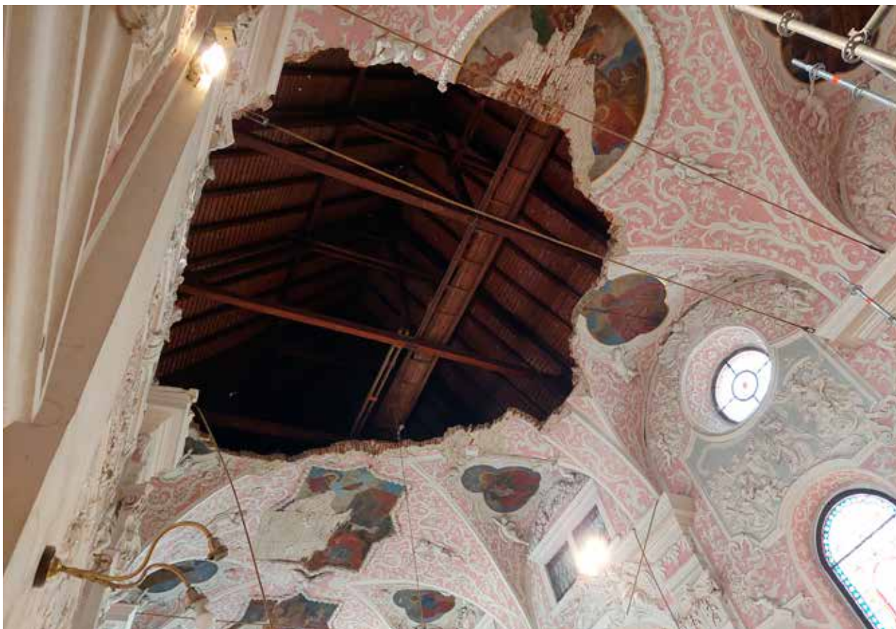
8 Oštećenje svoda akademске crkve sv. Katarine Aleksandrijske na Trgu Katarine Zrinske (fototeka GZZSKP, 2021.)
