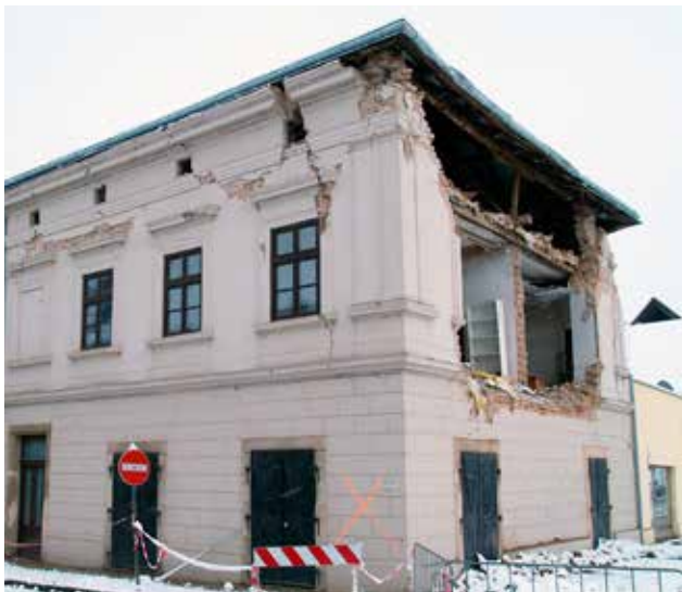
8 Petrinja, V. Nazora 13, stanje nakon potresa (foto: T. Petrinc, MKM, 2021.)
