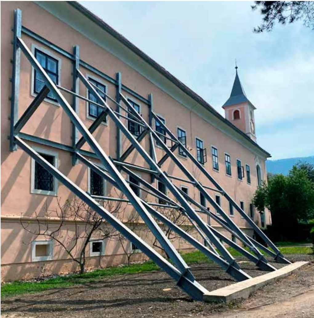
6 Gornja Bistra, dvorac Oršić, čelična konstrukcija na pilotima koja podupire južno pročelje, (foto: V. Jakaša Borić, KO ZG, 2022.) Gornja Bistra, Oršić Castle, steel structure on pilotis supporting the southern façade (photo: V. Jakaša Borić, Zagreb Conservation Department, 2022)
