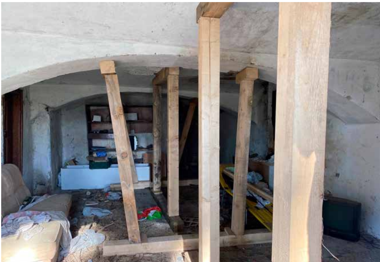
11 Gornja Pušća, kurija Rauch, podupore svoda u prizemlju (foto: V. Jakaša Borić, KO ZG, 2021.)
