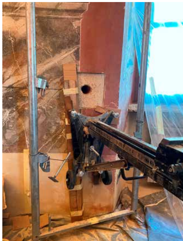
9 Gornja Bistra, dvorac Oršić, stroj kojim se izvodilo bušenje zidova u ovalnoj dvorani (foto: V. Jakaša Borić, KO ZG, 2022.)
