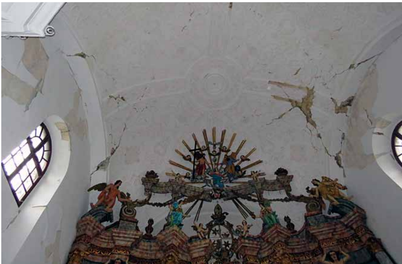
2 Pokupsko, župna crkva Uznesenja BDM/sv. Ladislava, štete od potresa na svodu svetišta (foto: M. Ožanić, KO ZG 2021.)
