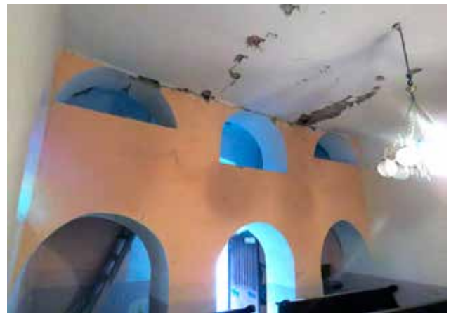
16 Kapela sv. Margarete na Brdu Karlovačkom, oštećenje stropa (foto: S. Kočevar, KO KA, 2021.) Chapel of St. Margaret on Brdo Karlovačko, damage to the ceiling (photo: S. Kočevar, Karlovac Conservation Department, 2021)
