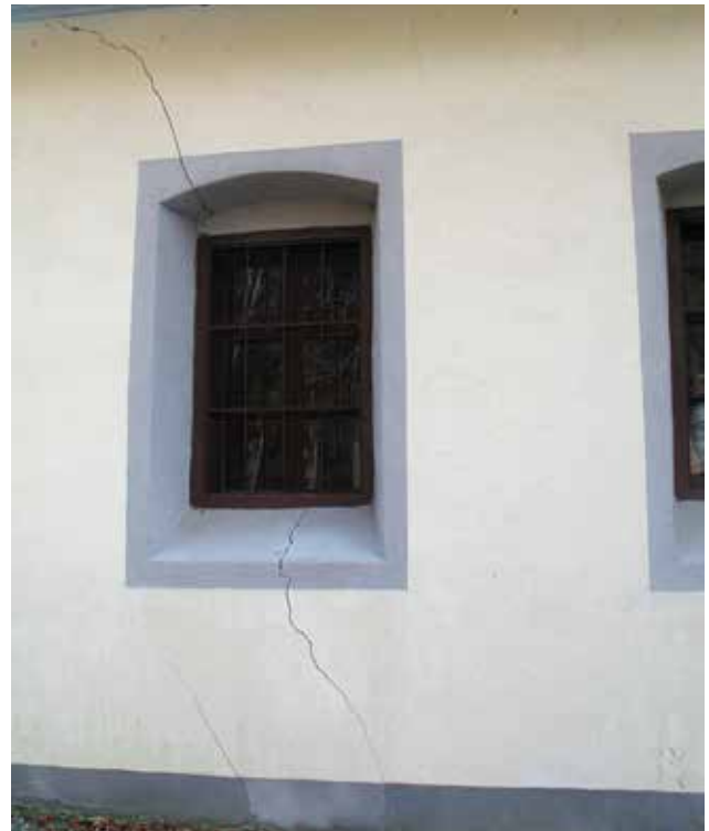
5 Kapela sv. Leonarda u Donjem Prilišću, pukotina poprečno na uzdužne zidove (foto: B. Križanić, KO KA, 2021.) Chapel of St. Leonardo in Donje Prilišće, a crack transverse to the longitudinal walls (photo: B. Križanić, Karlovac Conservation Department, 2021)
