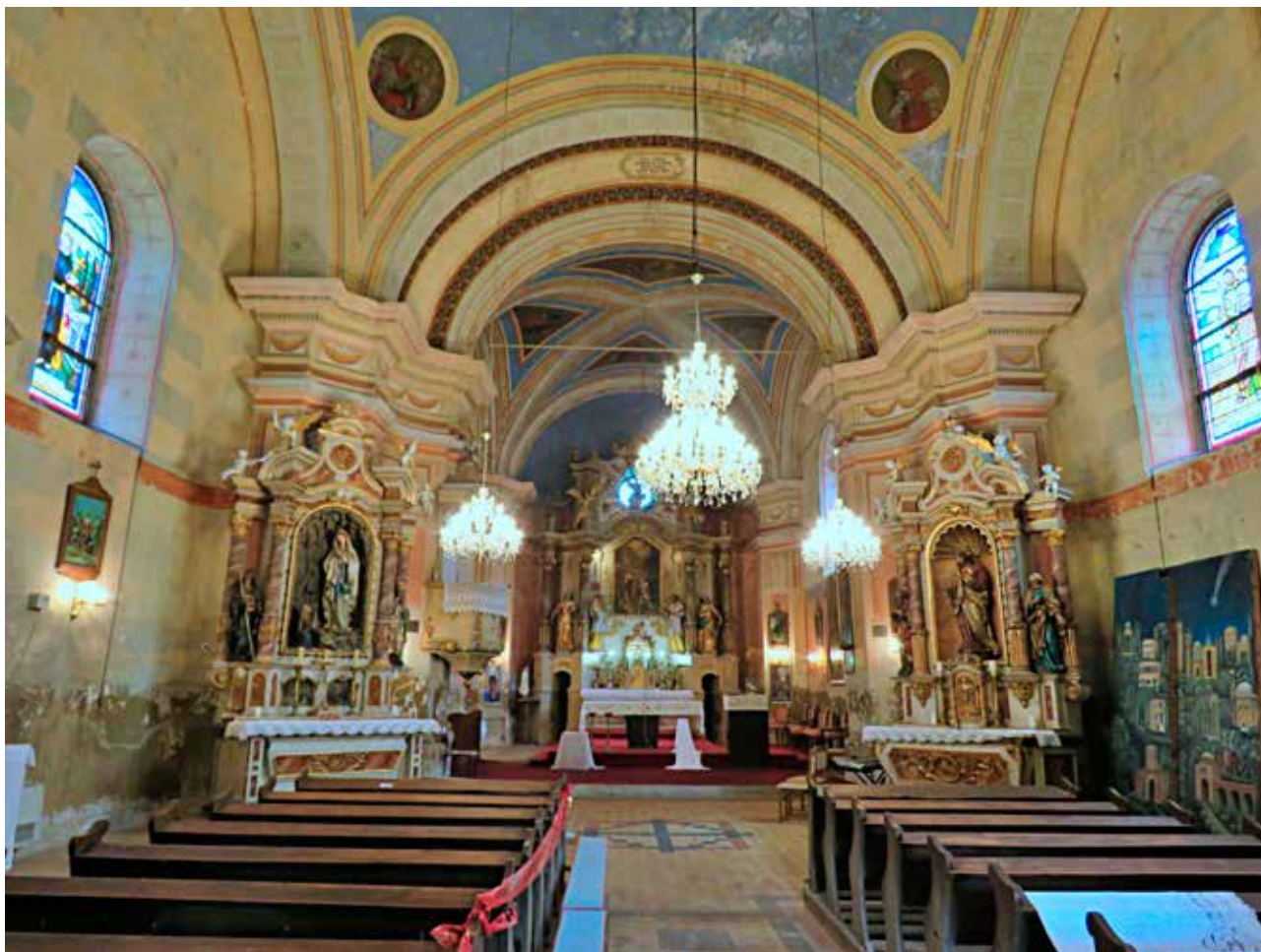
13 Crkva sv. Ivana Krstitelja u Rečici, oštećenje svodnog polja s naznačenom pozicijom odrezane zatege (foto: S. Kočevar, KO KA, 2021.) Church of St. John the Baptist in Rečica, damage to the vault panel with the indicated position of the cut tie-rod (photo: S. Kočevar, Karlovac Conservation Department, 2021)
