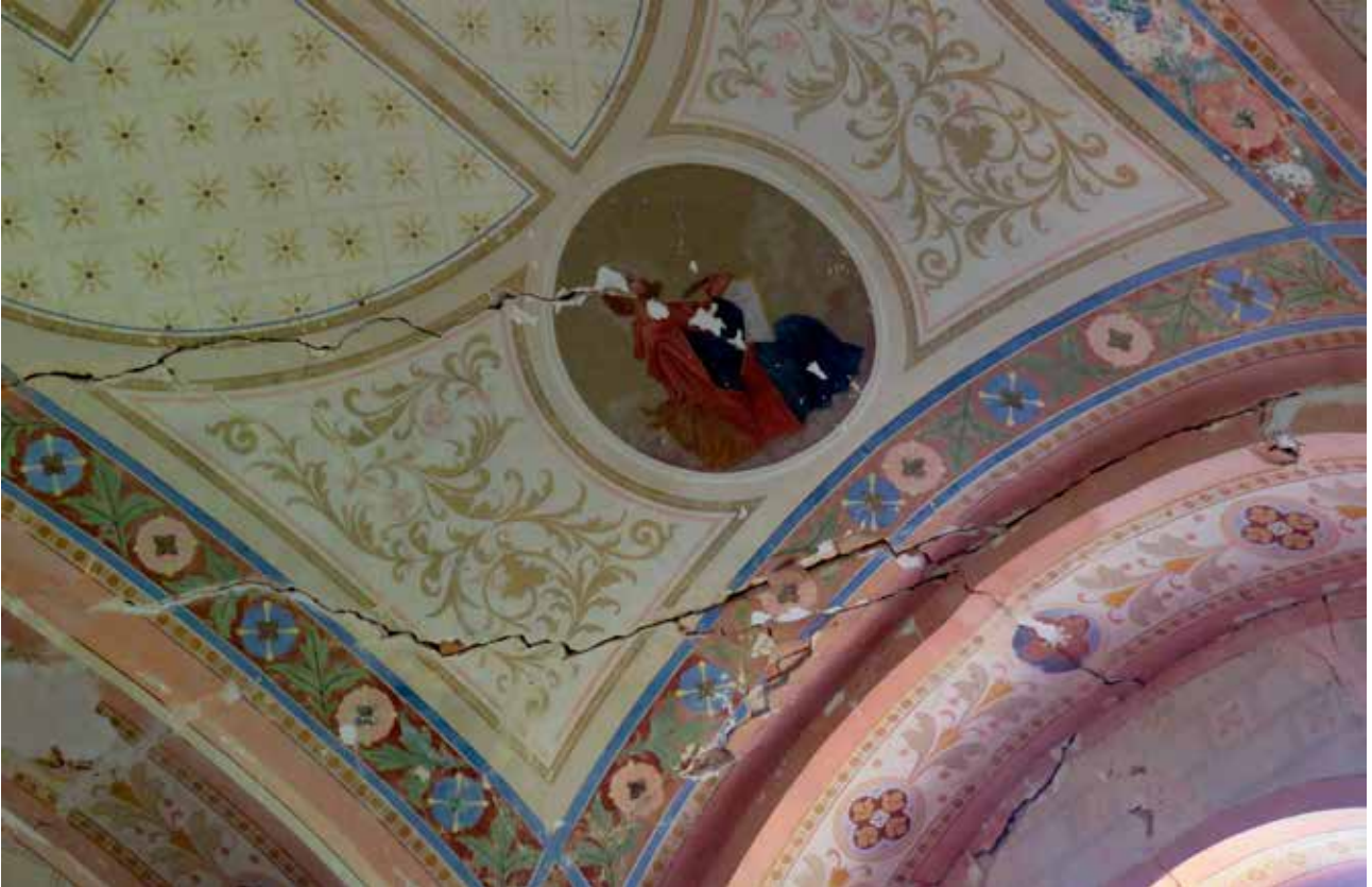
3 Crkva sv. Katarine u Kunićima Ribničkim, oštećenje svodnih polja (foto: S. Kočevar, KO KA, 2021.) Church of St. Catherine in Kunići Ribnički, damage to the vault panels (photo: S. Kočevar, Karlovac Conservation Department, 2021)
