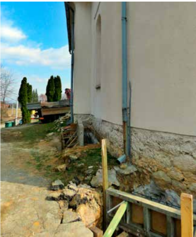
4 Crkva sv. Ivana Krstitelja u Svetičkom Hrašću, kampadna konsolidacija kamenog temelja (foto: S. Kočevar, KO ZG, 2022.) Church of St. John the Baptist in Svetičko Hrašće, sequenced consolidation of the stone foundation (photo: S. Kočevar, Karlovac Conservation Department, 2022)
