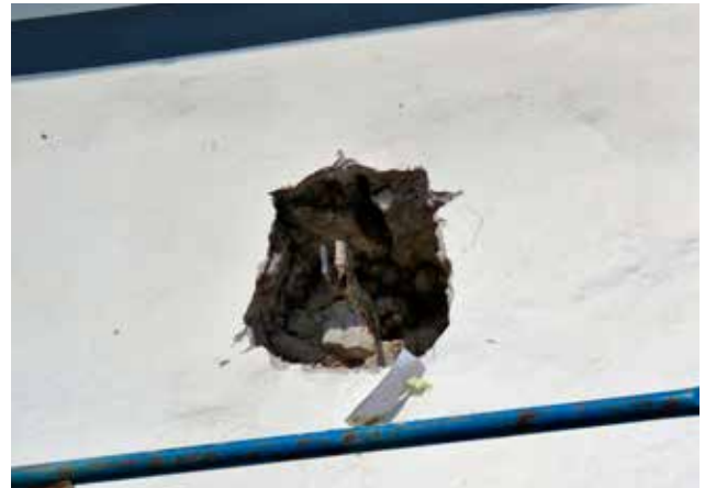
15 Crkva Svih Svetih u Trgu kod Ozlja, nefunkcionalna zatega bez fiksacijskih križeva na pročelju (foto: S. Kočevar, KO KA, 2022.) Church of All Saints in Trg near Ozalj, non-functional tie-rod without cross-shaped anchor plates on the main façade (photo: S. Kočevar, Karlovac Conservation Department, 2022)
