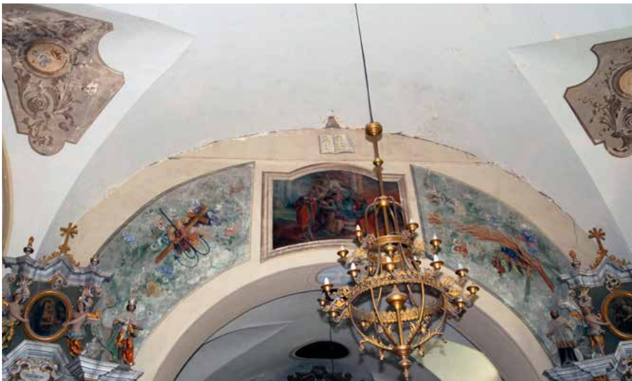
9 Samarica, crkva sv. Katarine, oštećenje kontaktne zone svoda i trijumfalnog luka (foto: M. Pezelj, KO BJ, 2022.)
