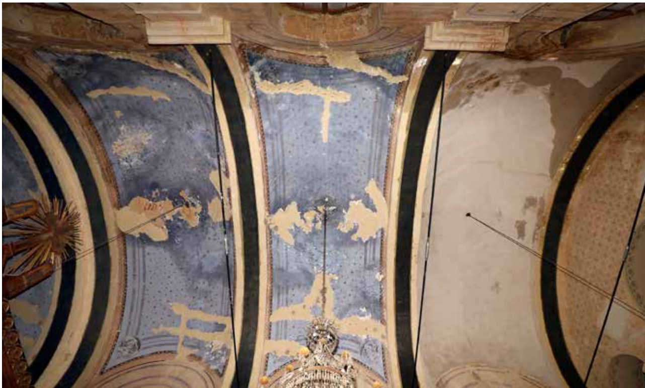
8 Velika Barna, crkva sv. Marka, svodovi nakon hitnih mjera (foto: M. Pezelj, KO BJ, 2023.)
