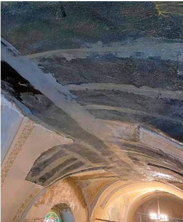
6 Maruševac, crkva sv. Jurja mč., sanacija oštećenja primjenom FRP sustava (foto: V. Pascuttini-Juraga, KO VŽ, 2021.)
