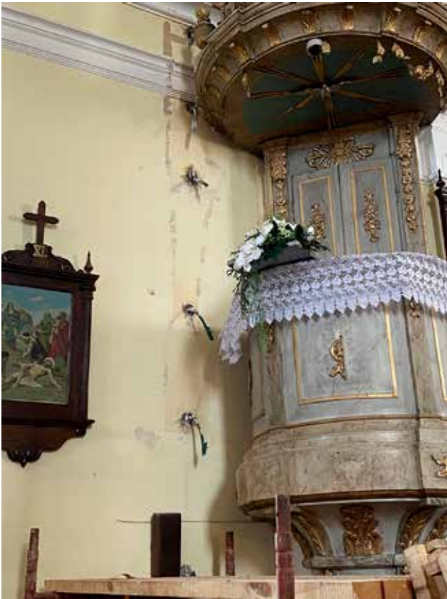
3 Draškovec, crkva sv. Roka, sanacija oštećenja nastalih u potresu injektiranjem (foto: V. Pascuttini-Juraga, KO VŽ, 2022.)
