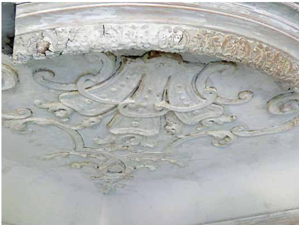
7 Novi Marof, Dvorac Erdödy, novootkriveni stropni oslik sa štukaturom tijekom radova (foto: I. Peharda, KO VŽ, 2023.)
