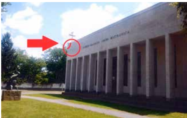
11 Spomen galerija Ivana Meštrovića u Vrpolju – oštećenja pročelja (foto: Ž. Perković, KO SB, 2021.)
