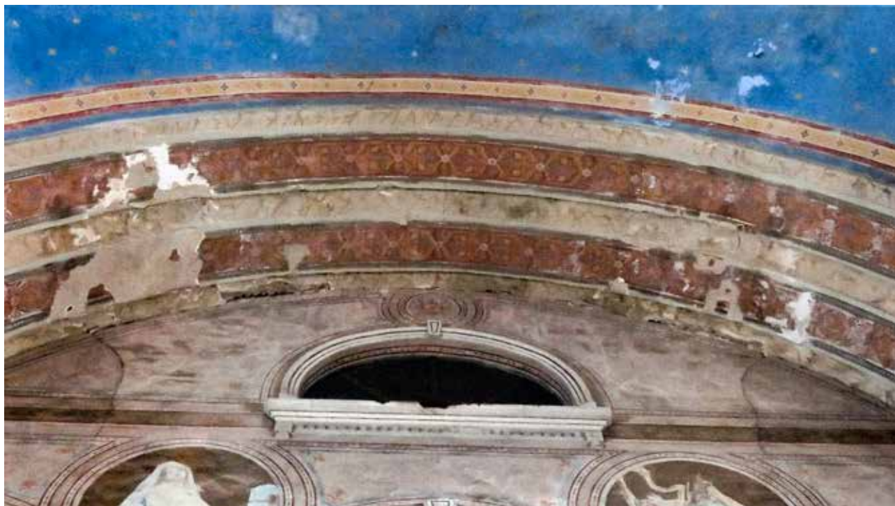
4 Nova Gradiška, Župna crkva Bezgrješnog začeca BDM – oštećenja na spoju zida kora i svoda broda crkve (Fibra d.o.o Osijek, 2021.)
