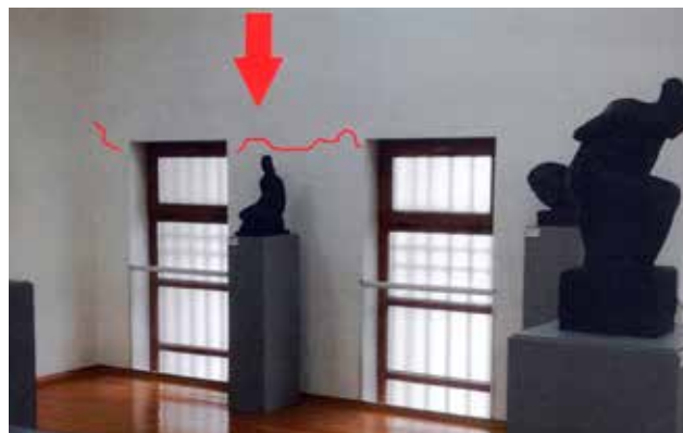
12 Spomen galerija Ivana Meštrovića u Vrpolju – oštećenja zidova (foto: Ž. Perković, KO SB, 2021.)
