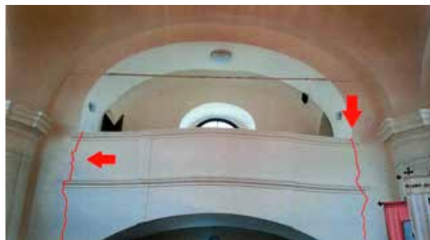
8 Dubočaj, crkva Sv. Mihaela Arkandela – oštećenja na koru (foto: Ž. Perković, Konzervatorski odjel u Slavonskom Brodu - dalje KO SB 2021.)
