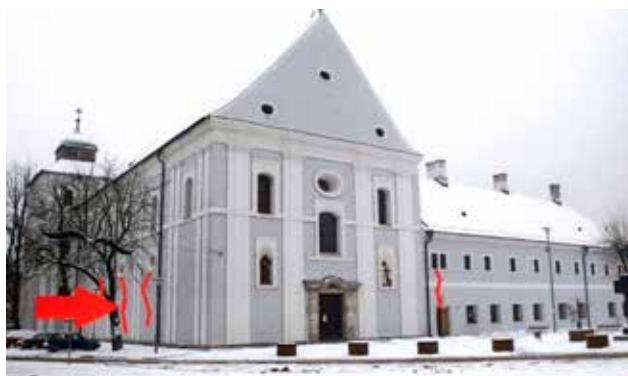
6 Franjevački samostan i crkva sv. Trojstva – oštećenja pročelja (foto: Ž. Perković, KO SB, 2021.)
