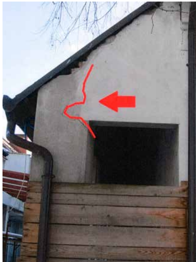
10 Zgrada gradskog magistrata u Slavonskom Brodu – oštećenja (foto: Ž. Perković, KO SB, 2021.)
