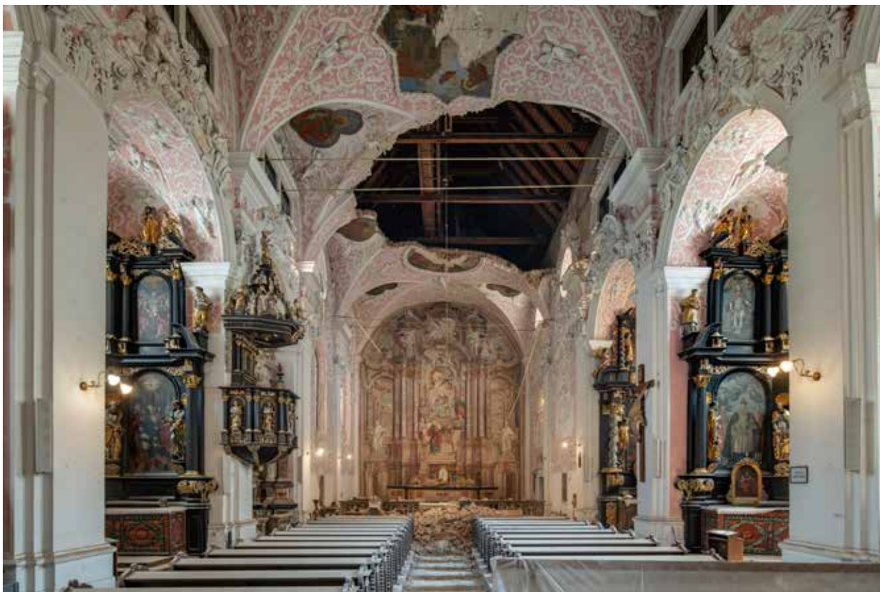
1 Oštećenja svoda crkve sv. Katarine uzrokovana potresima 2020. godine, pogled prema svetištu (foto: G. Tomljenović, HRZ, 2020.)
