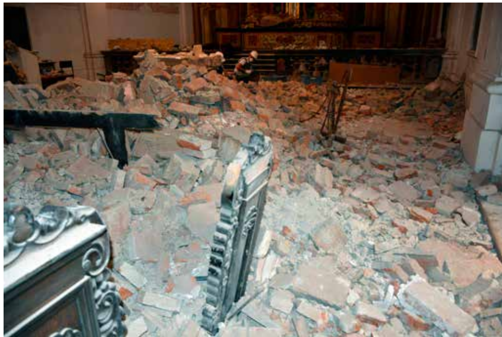
5 Urušena građa svoda, pogled prema svetištu crkve, stanje 2022. (foto: M. Jelenčić, HRZ, 2022.)
