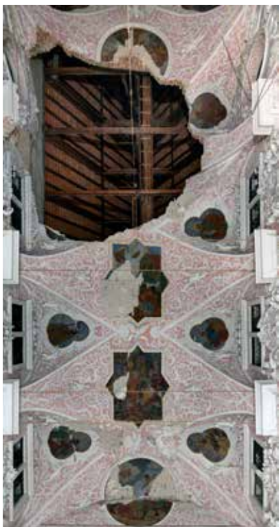
2 Pogled na oštećenja svoda crkve sv. Katarine uzrokovana potresima 2020. godine (foto: G. Tomljenović, HRZ, 2020.)
