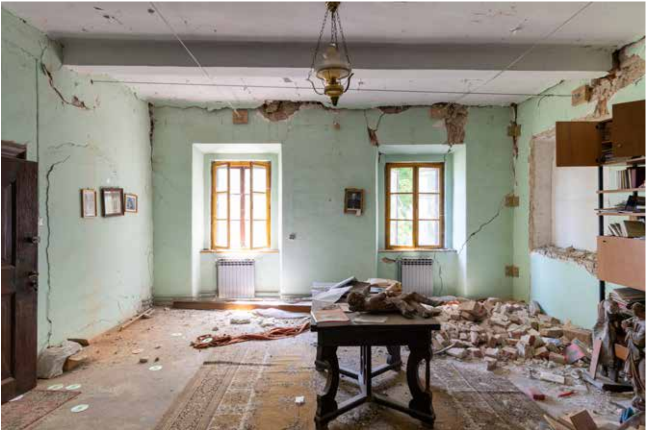
14 Župni dvor u Selima, unutrašnjost – stanje nakon potresa (foto: LJ. Gamulin, fototeka HRZ, 2022.)
