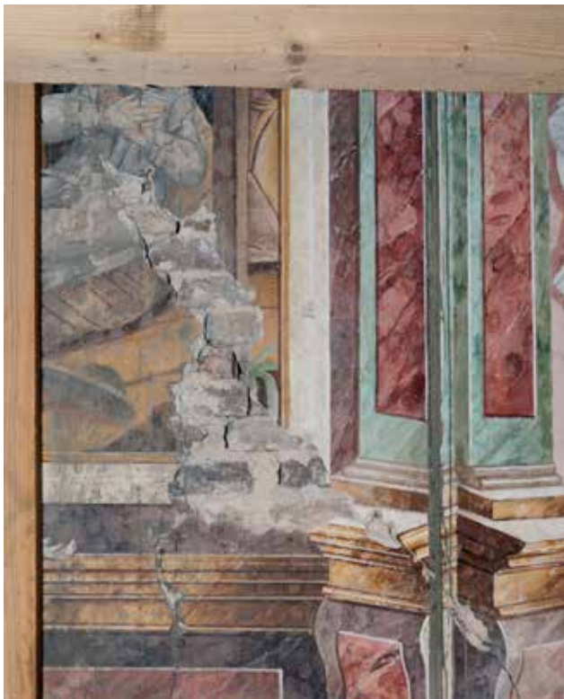
10 Crkva sv. Marije Magdalene u Selima, oštećenje zidnog oslika nakon potresa (foto: K. Gavrilica, fototeka HRZ, 2022)
