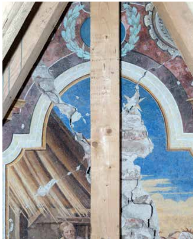
11 Crkva sv. Marije Magdalene u Selima, oštećenje zidnog oslika nakon potresa (foto: K. Gavrilica, fototeka HRZ, 2022)
