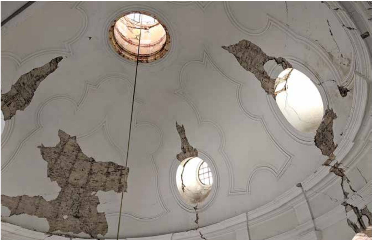
7 Crkva sv. Marije Magdalene u Selima, oštećenja štukature na svodu kupole nakon potresa (foto: G. Tomljenović, fototeka HRZ, 2021.) Church of St. Mary Magdalene in Sela, damage to the stucco on the vault of the dome after the earthquake (photo: G. Tomljenović, Croatian Conservation Institute photo archive, 2021)
