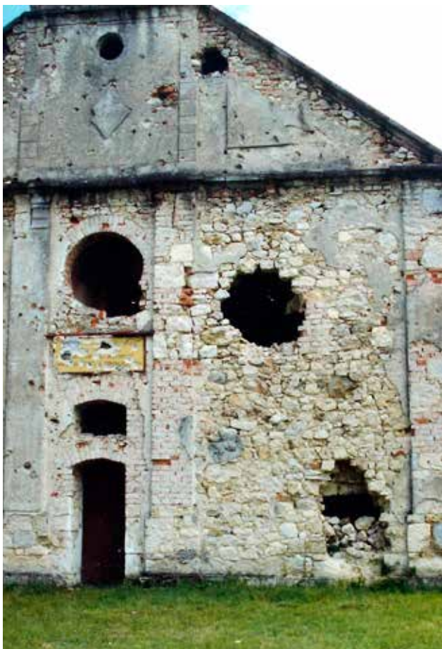
7 Kapela Presvetog Trojstva, zapadno pročelje, oštećenja u Domovinskom ratu, lipanj 1998. (foto: T. Petrincec, KO ZG, inv. br. I-46634)
