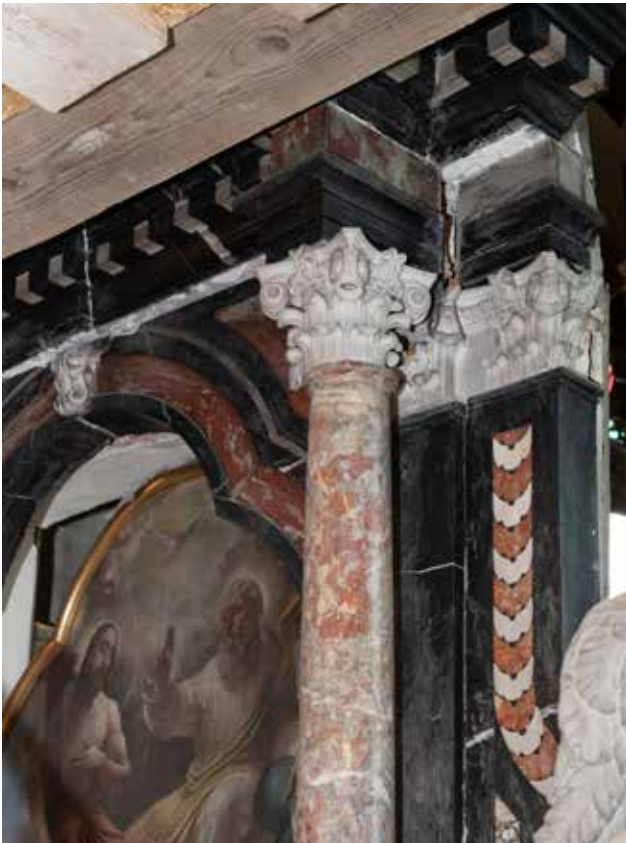
3 Remete, župna crkva Uznesenja Blažene Djevice Marije, detalj oštećenja i potporne skele glavnog oltara financirane sredstvima ALIPH-a (foto: G. Tomljenović, HRZ, 2020.)
