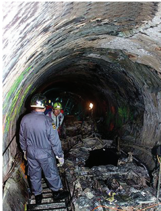
Sl. 3. Tunel uspinjače nakon požara
