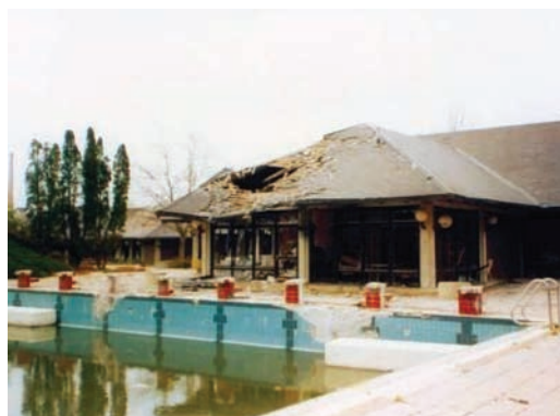
Sl. 8. Uništeni vanjski bazeni
