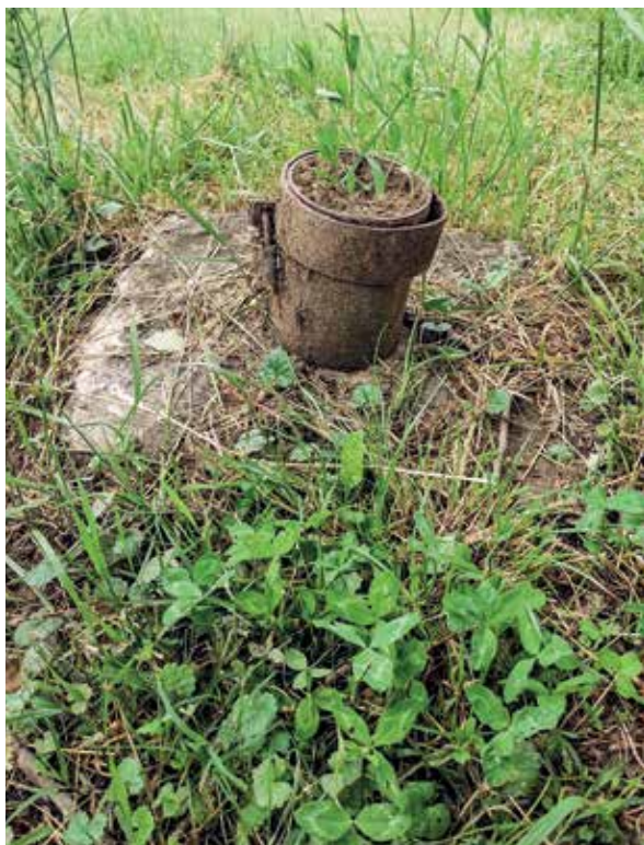
Slika 3: Oštećeni piezometar s područja Zagreba
