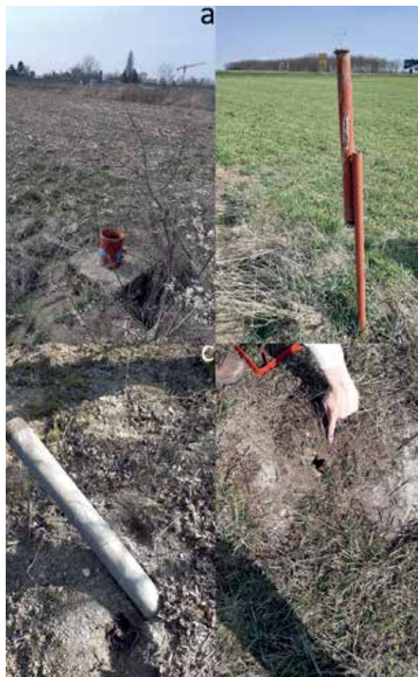
Slika 4: Oštećeni piezometri na širem području Velike Gorice
