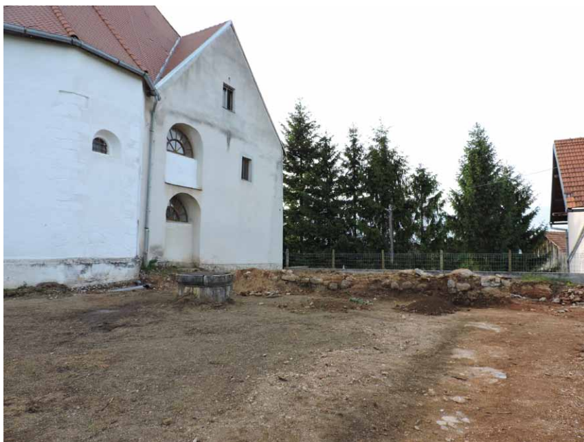
Slika 14. Pogled na dvorište samostana za vrijeme arheoloških istraživanja s ostacima zida 1 i zida 2 (foto: Miroslav Razum).
