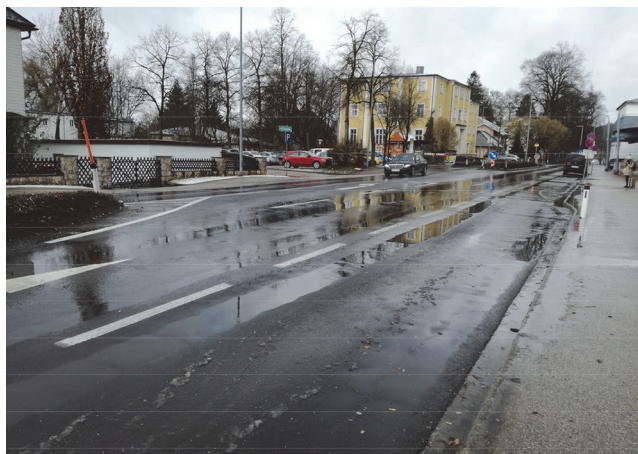
Slika 1. Kolotrazi i deformacije asfalta uslijed preopterećenja uzrokovanih kočenjem, zaustavljanjem te pokretanjem u blizini raskrižja i na autobusnim stajalištima [autor, 2020.]
