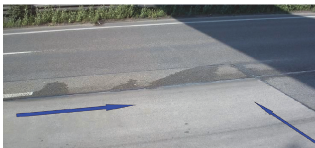
Slika 19. Problem: istjecanje vode na mjestu spoja asfalta i betona [8]
