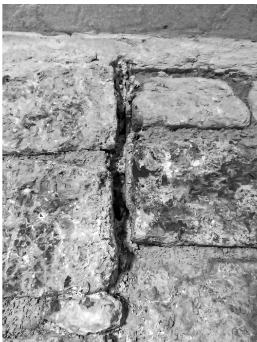
Sl. 4. Ostaci žbuke sa začelja prvotne, srednjovjekovne crkve u fugi na spoju starog i novog dijela istočnog zida
