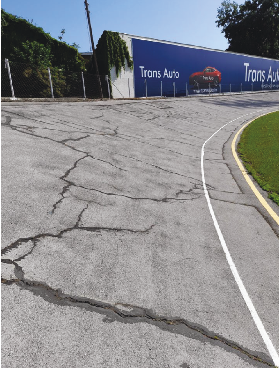
Slika 13. Oštećenost sjeveroistočnog dijela Velodroma (travanj 2021.).
