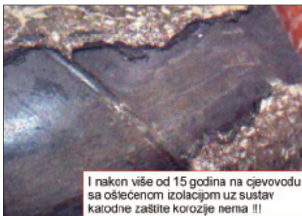
Slika 9. Čelični cjevovod s oštećenom izolacijom i s katodnom zaštitom, bez korozije i stalno u funkciji (slika iz 1999.) – fizički dokaz učinkovitosti katodne zaštite na otkopanom cjevovodu
