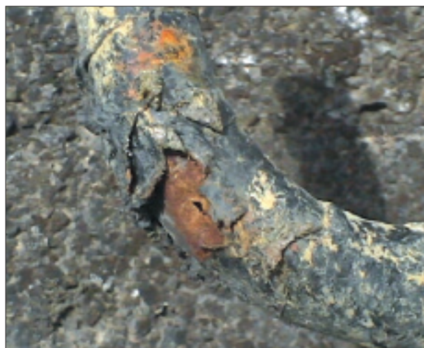
Slika 1 i slika 2. Čelični cjevovodi s oštećenom izolacijom i bez katodne zaštite – prekid u radu zbog korozije < 1 – 3 godine funkcije
