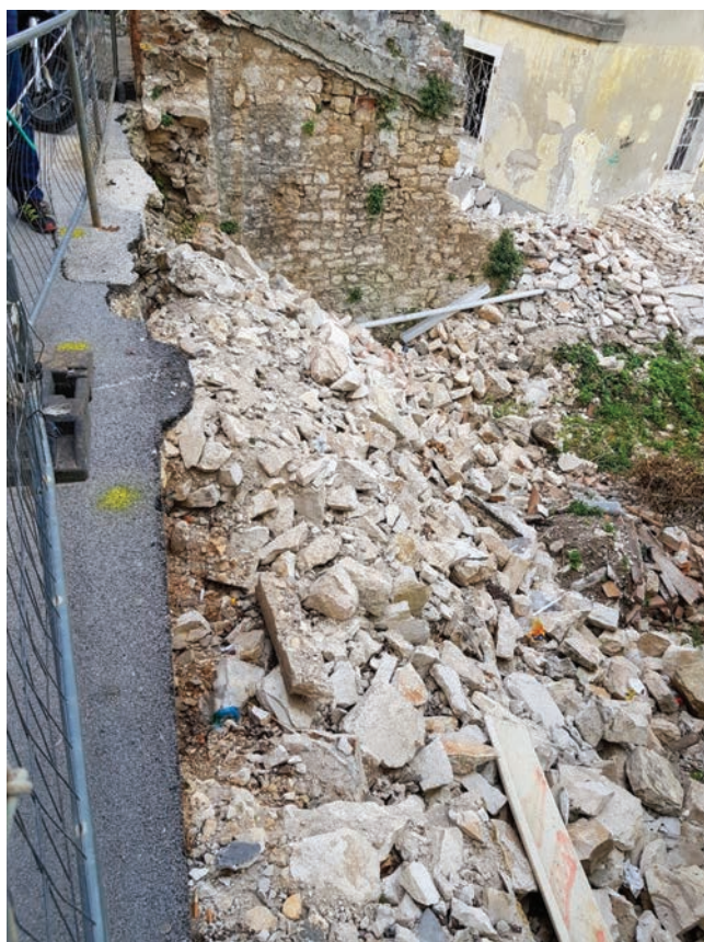
Sl. 1 Pogled na urušeni zid u ulici Castropola 31 (fotografija: T. Šalov). Fig. 1 The collapsed wall at No. 31 Castropola street (photo: T. Šalov).
