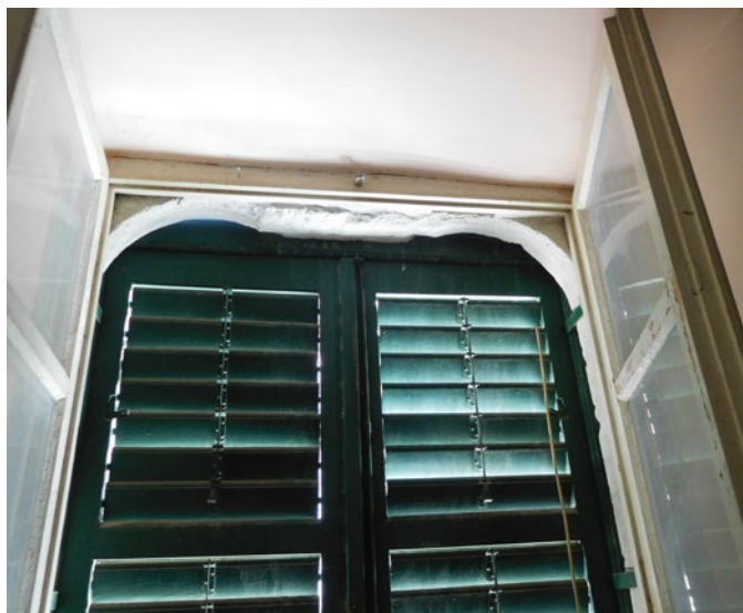
9a. Ostatak bifore na unutrašnjoj strani prozora na bočnom pročelju palače Rossini (foto: I. Šprljan)
