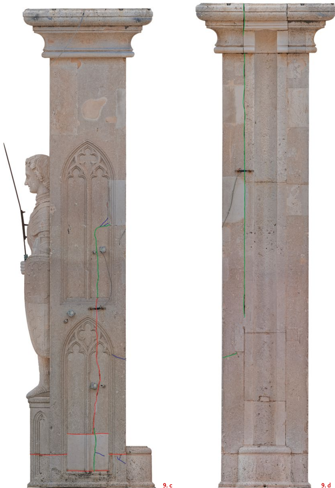
9. Pogledi na razvijeno tijelo Orlandova stupa sa shematskim prikazom pukotina zabilježenih od 2003. do 2018. godine (arhiva HRZ-a, izradila: V. Marinković, 2024.) View of the pillar of Orlando's Column with a schematic representation of cracks recorded between 2003 and 2018 (HRZ Archive, V. Marinković, 2024)
