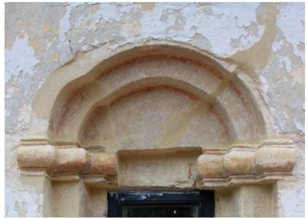
12. Stanje kamenog okvira prozora tambura nakon sanacije (snimka: Z. Vukosavljević, 2021.) Condition of the stone frame of the drum window after renovation (Z. Vukosavljević, 2021)
