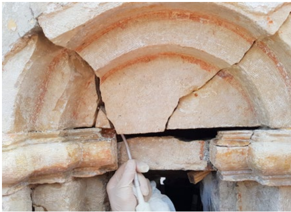
11. Stanje kamenog okvira prozora tambura prije sanacije (snimka: Z. Vukosavljević, 2021.) Condition of the stone frame of a drum window before renovation (Z. Vukosavljević, 2021)
