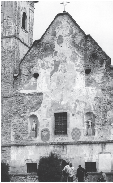
Sl. 5. Pogled na dio pročelja crkve sv. Jeronima, obnovljeno 1925., stanje godine 1985. Fototeka HRZ, Odjel za zidno slikarstvo i mozaik.
