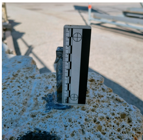
Slika 26. Detalj metalnog vertikalnog sidra zalivena olovom (foto: D. Foretić, 2025.)
