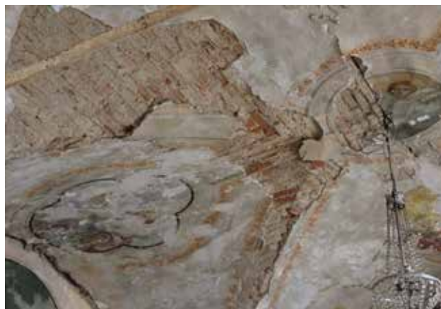
17 Oštećenja svoda svetišta kapele sv. Mihalja u Vugrovcu (Fototeka, GZZSKP, 2022.)
