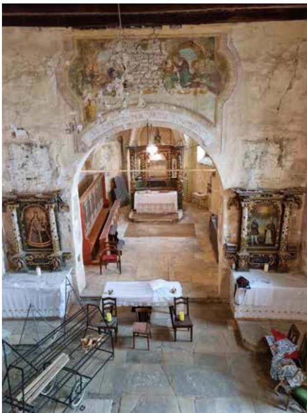
16 Oštećenja kapele sv. Mihalja u Vugrovcu u potresu iz ožujka 2020. (Fototeka, GZZSKP, 2022.)
