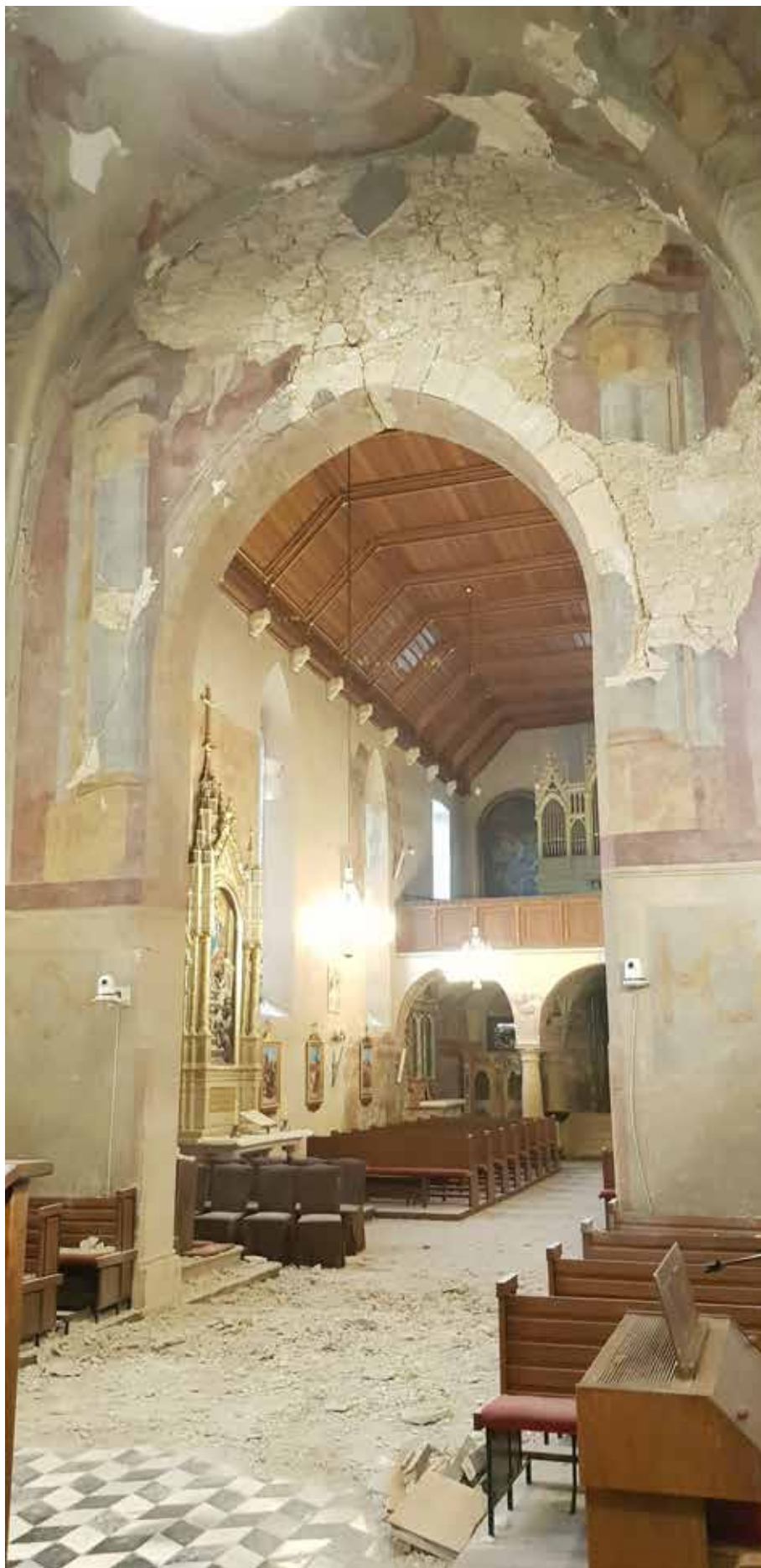
18 Oštećenja na zidom osliku i građi trijumfalnog luka, pogled iz svetišta crkve Uznesenja Blažene Djevice Marije u Remetama (Fototeka, GZZSKP, 2020.)
