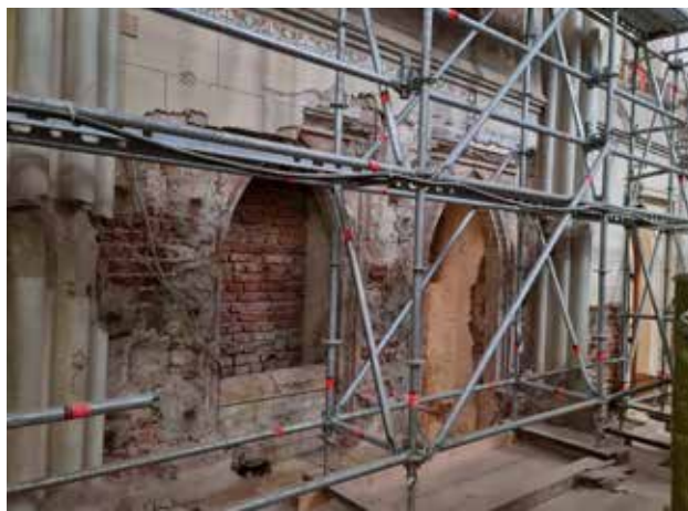
10 Zazidani gotički otvori u južnom zidu svetišta crkve sv. Franje Asiškog na Kaptolu (Fototeka GZZSKP, 2021.)
