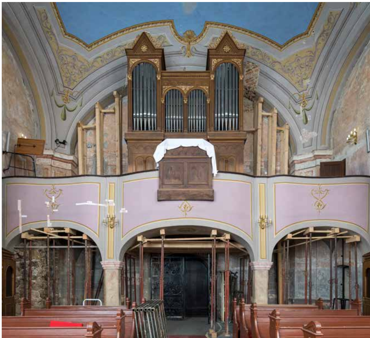
5 Pogled prema pjevalištu – podupiranje nestabilnih dijelova kroz hitne intervencije (foto: Katarina Gavrilica, HRZ, 2022.)
