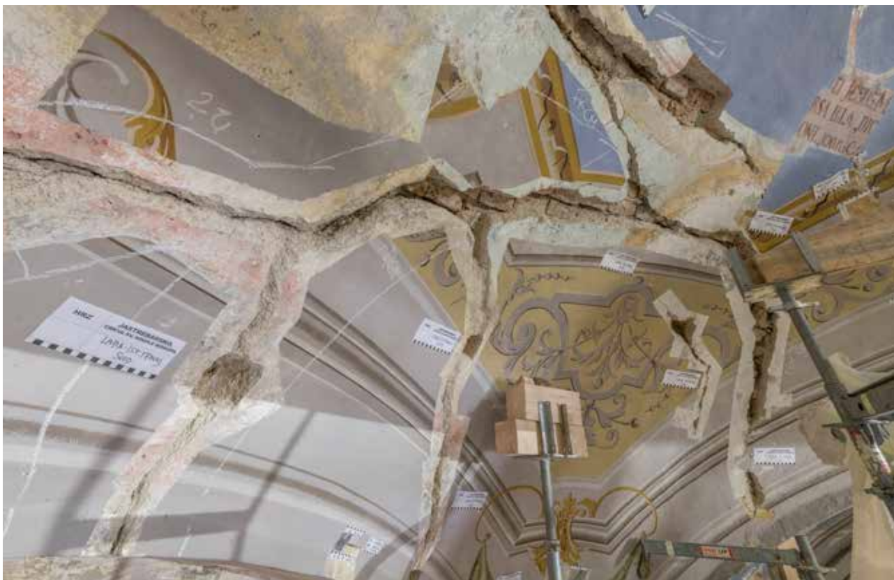
7 Istočni svod, ciljane sonde duž pukotina (foto: Katarina Gavrilica, HRZ, 2023.)
