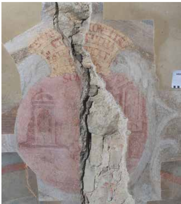
11 Oslík iznad nadvoja prozora na zapadnom zidu – detalj oštećenja (foto: Katarina Gavrilica, HRZ, 2023.)
