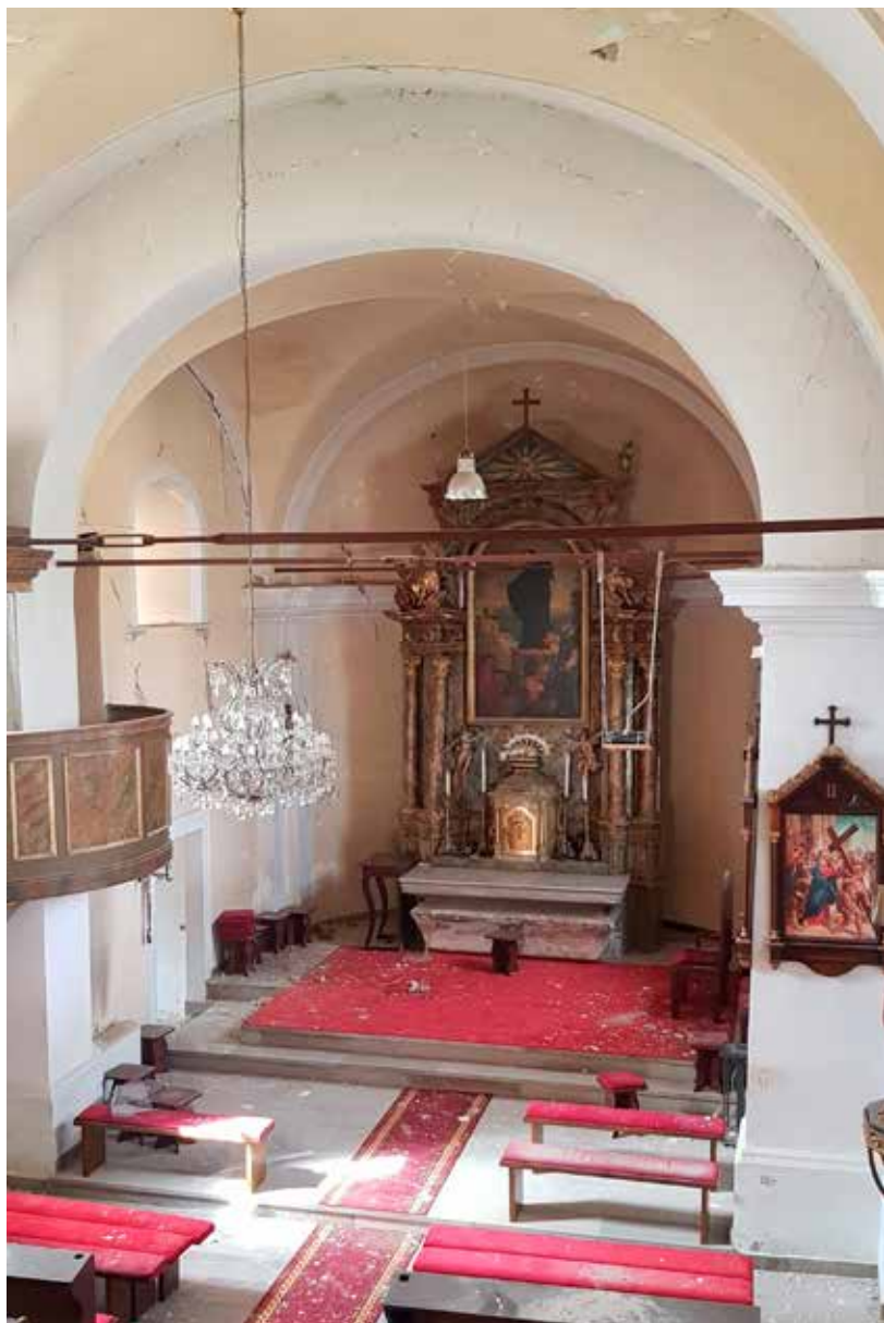
2 Vugrovec, župna crkva sv. Franje Ksaverskog, unutrašnjost crkve nakon potresa (foto: S. Novak, GZZSKP, 2020.)
