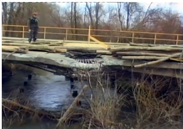
Slika 4. Oštećeni most na cesti Gaj – Kukunjevac na rijeci Bijela
