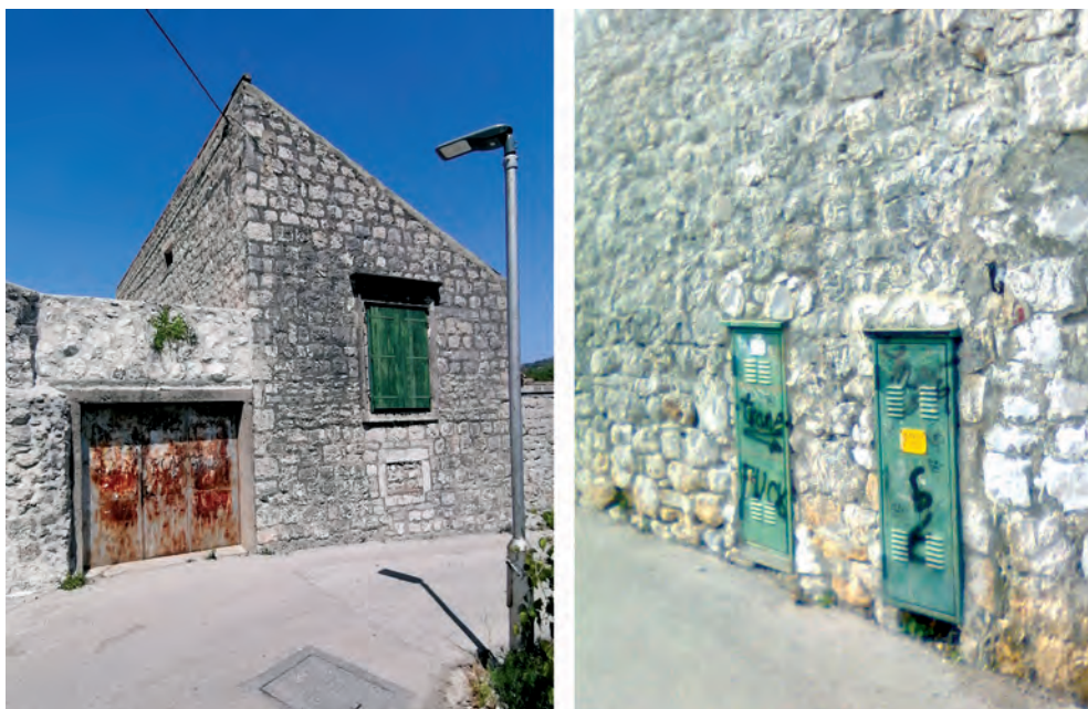
Bespravna garaža uz istočni zid, zastarjele instalacije u istočnom zidu
