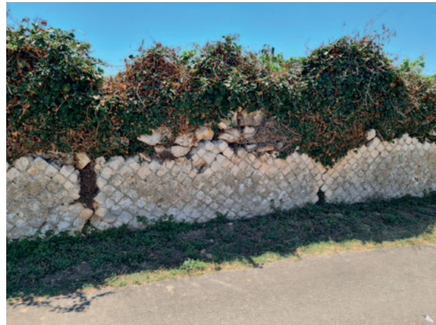
Sl. 5 Zid izgrađen tehnikom opus reticulatum (snimio: S. Krznar) Fig. 5 Wall built using the opus reticulatum technique (photo by: S. Krznar)
