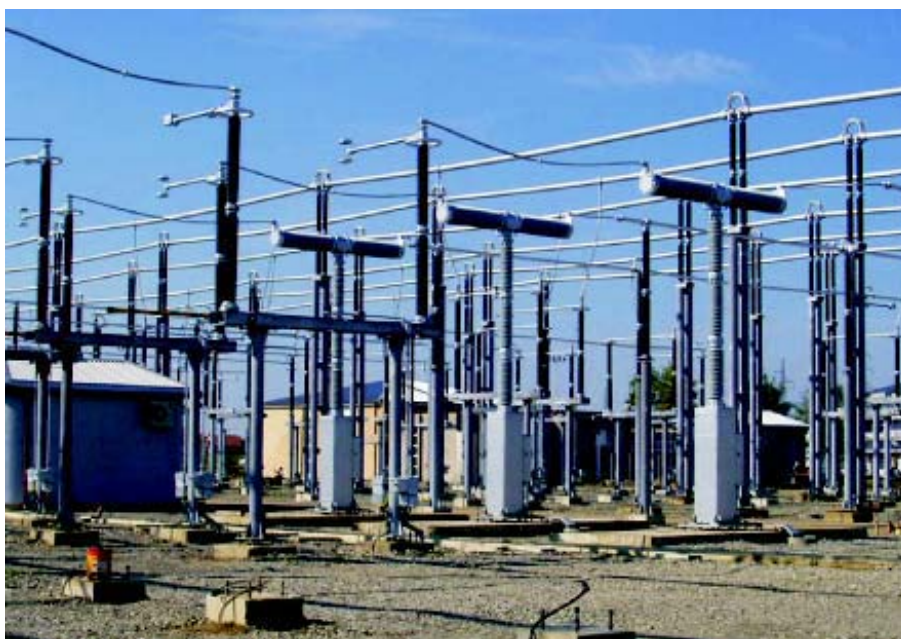
Slika 13. Pogled na dio sabirničkog sustava u TS Ernestinovo nakon izgradnje postrojenja
