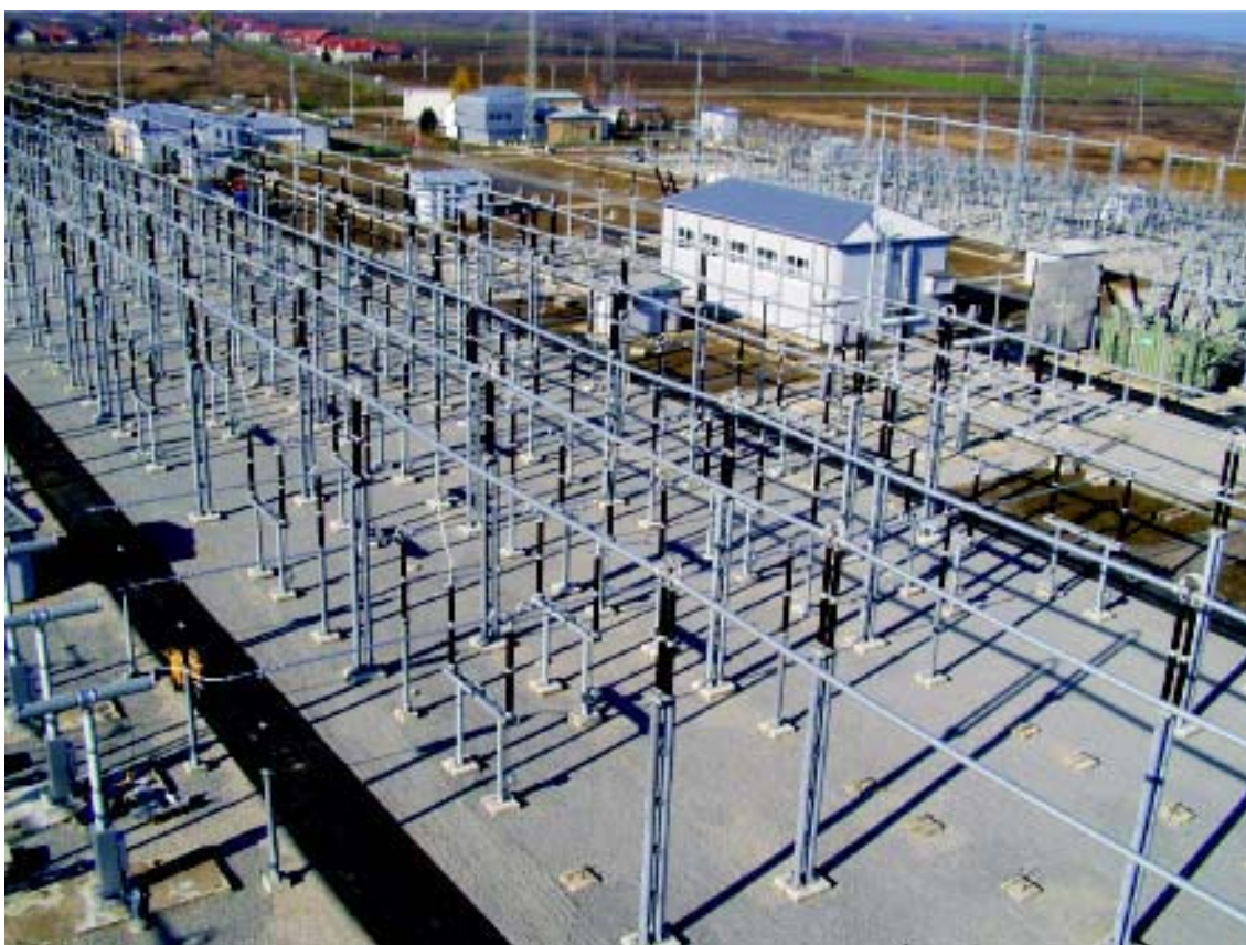
Slika 9. Pogled na sabirnički sustav 400 kV u TS Ernestinovo
