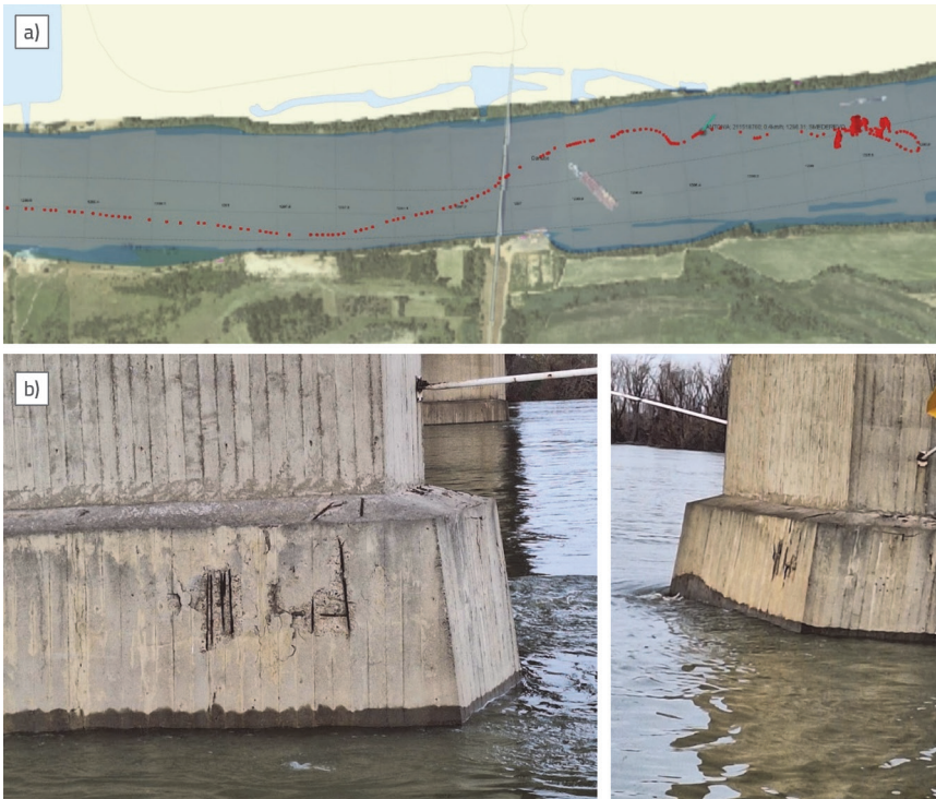
Slika 5. a) Putanja plovila; b) oštećeni stup mosta [29]
