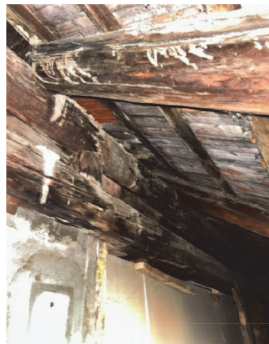
Slika 4. Drvena konstrukcija oštećena djelovanjem bioloških nametnika
