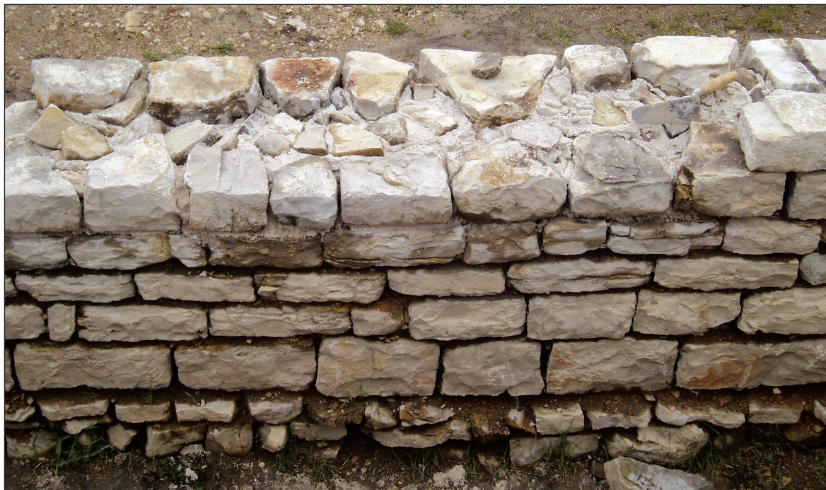
Sl. 3. Konzervacija zida urbane arhitekture na istočnom djelu Aserije Fig. 3. Conservation of walls of urban architecture in the eastern part of Asseria
