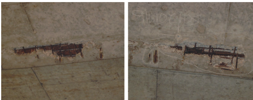
Slika 11. Oštećenja armature mosta.
