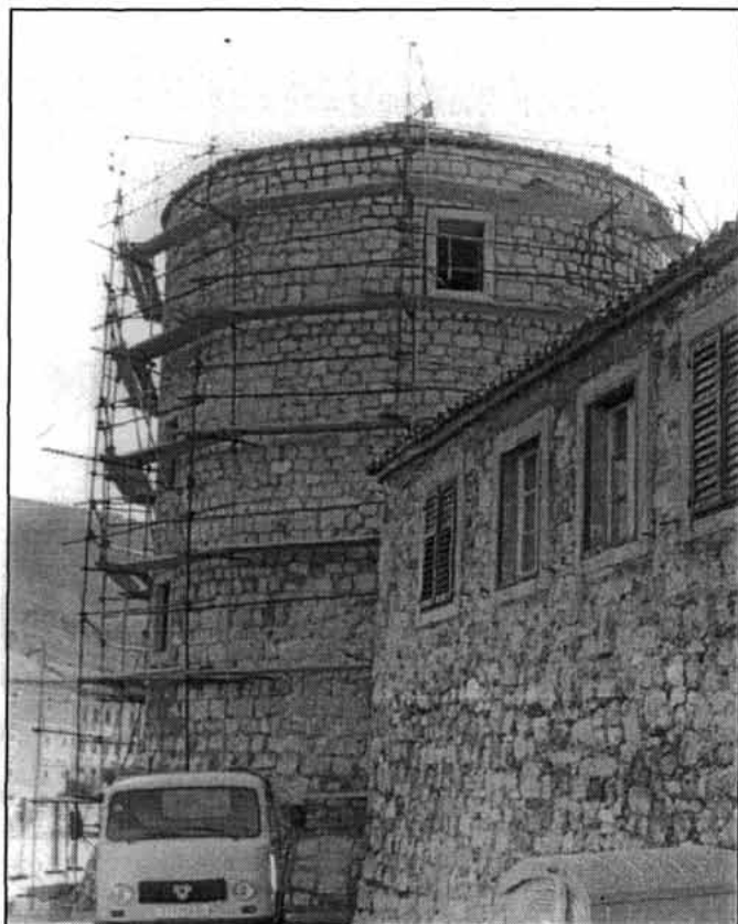
Sl. 10. Obalna utvrda kula Šabac, obnova vanjskog bedema sa zapadne strane, snimka od zapada A. Glavičić, 1997.
